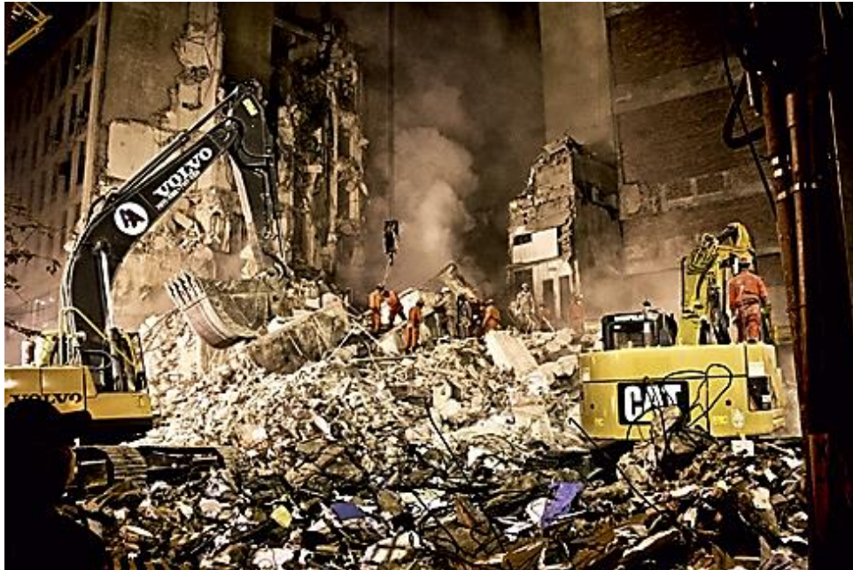
Figura 1.6 - Edifício Liberdade após desabamento
