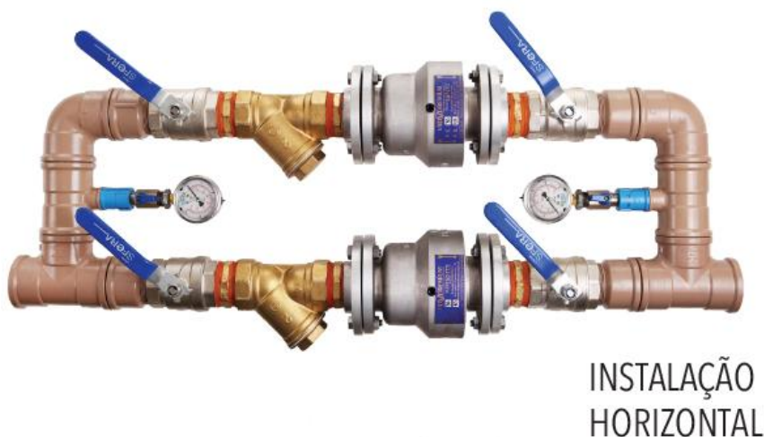
Figura 19 – Instalação horizontal da Válvula Redutora de Pressão.
