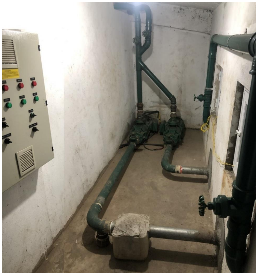
Figura 30 – Casa de bombas no Subsolo 2 com a elevatória de água potável.
