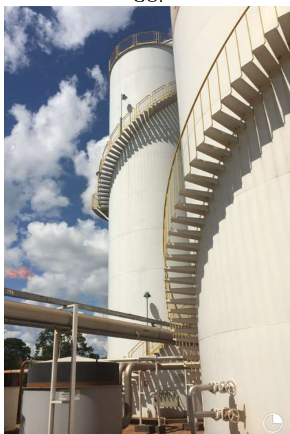
Figura 17 - Reator industrial UASB - Tratamento de efluentes, Kraft/Heinz, Neropolis - GO.
