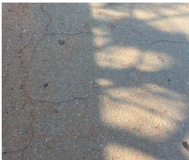
Figura 34 - Trincas e fissuras na pista experimental
