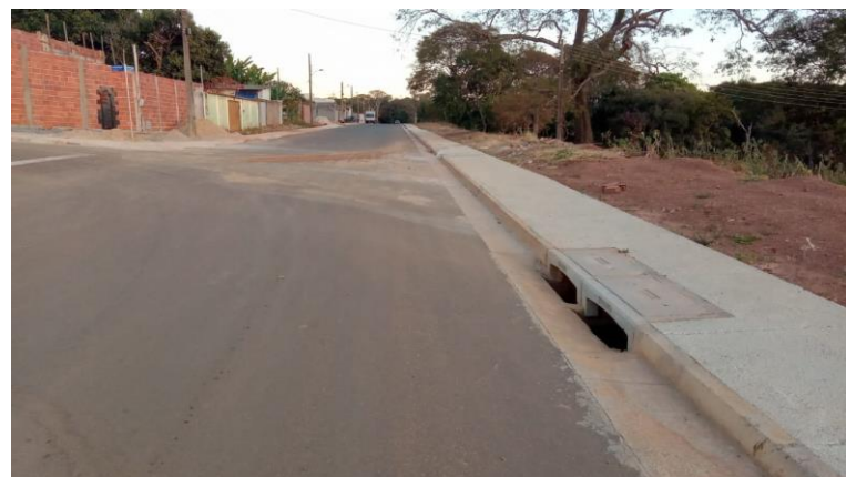
Figura 29 – Boca de lobo dupla na rua dos Industriários
