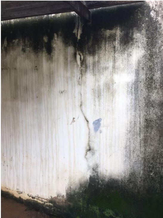
Figura 38 - Mofo na alvenaria
