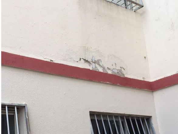
Figura 24 - Trincas e Pintura danificada
