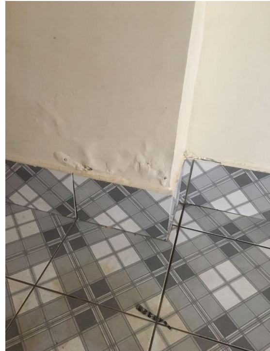
Figura 23 - Infiltração e Pintura danificada
