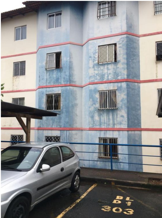
Figura 34 - Fissuras e Pintura danificada
