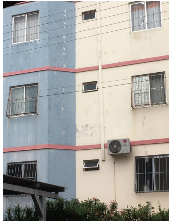
Figura 35 - Fissuras e Pintura danificada
