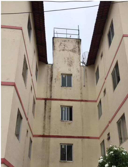
Figura 40 - Mofo na alvenaria
