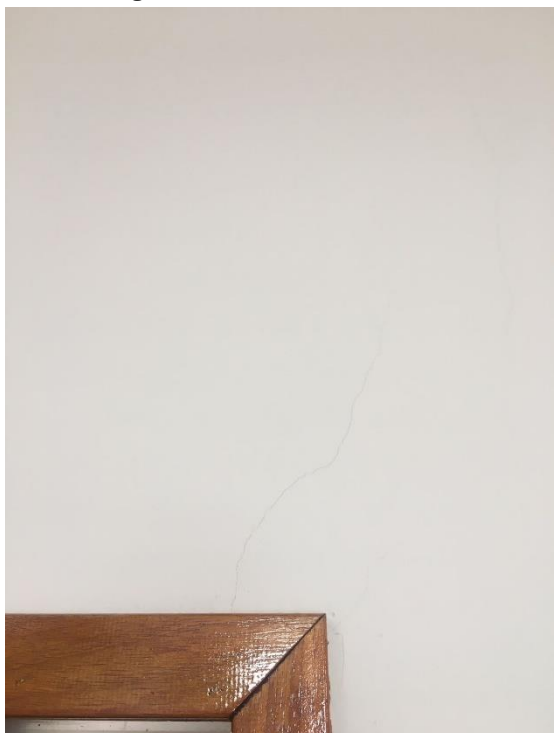
Figura 26 - Fissuras na alvenaria
