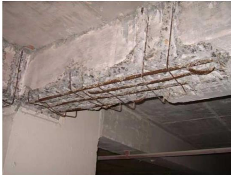
Figura 4- Desagregação do concreto em uma viga.
