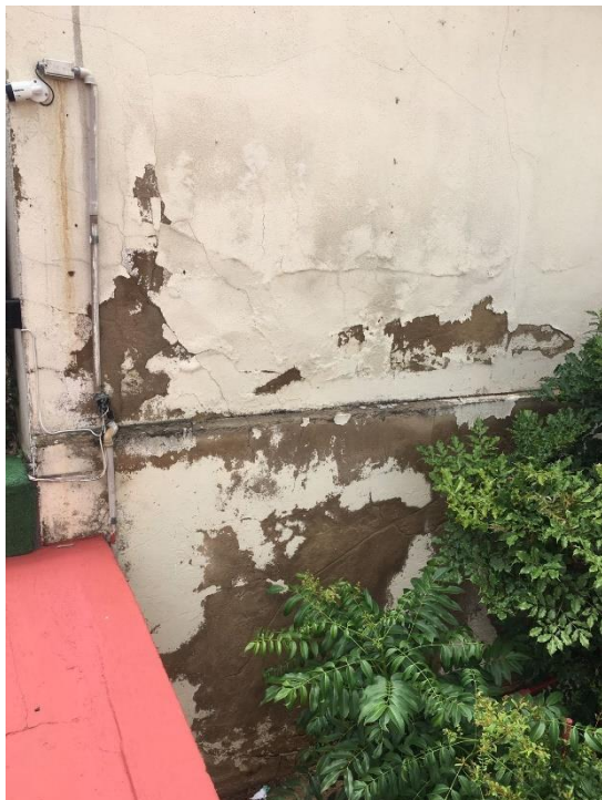
Figura 22 – Infiltração e Pintura danificada
