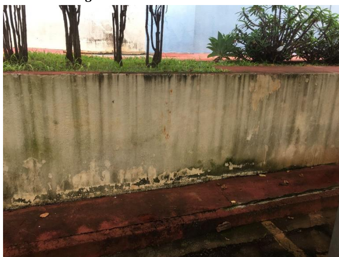
Figura 43 - Mofo no muro de arrimo
