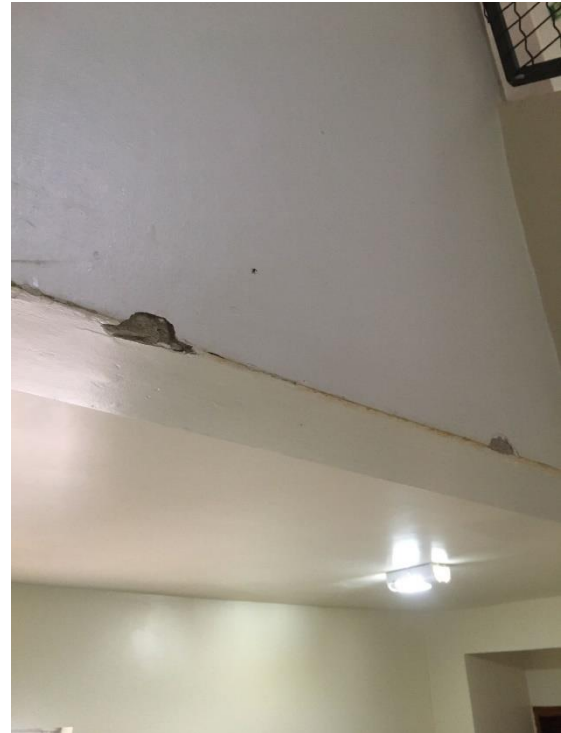
Figura 37 - Reboco e pintura danificada
