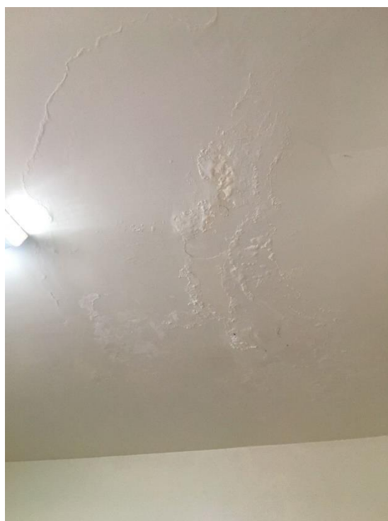
Figura 21 – Infiltrações na laje
