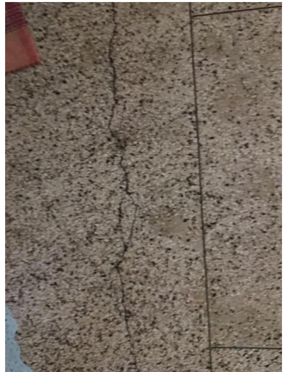
Figura 31 - Trincas no piso
