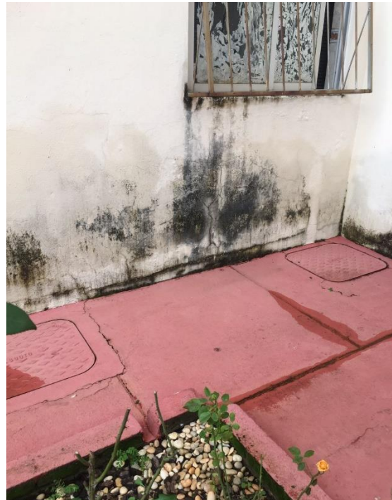
Figura 41 - Mofo na alvenaria
