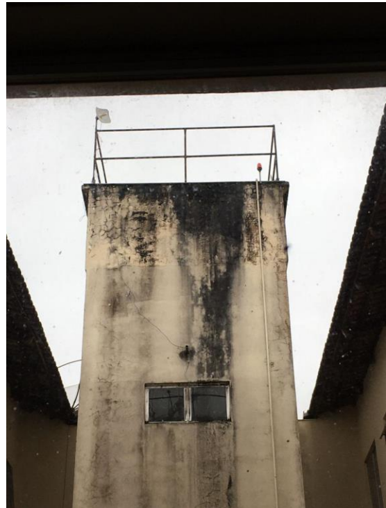
Figura 39 - Mofo na alvenaria
