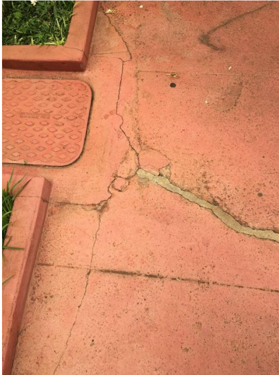
Figura 32 - Trincas e fissuras no piso
