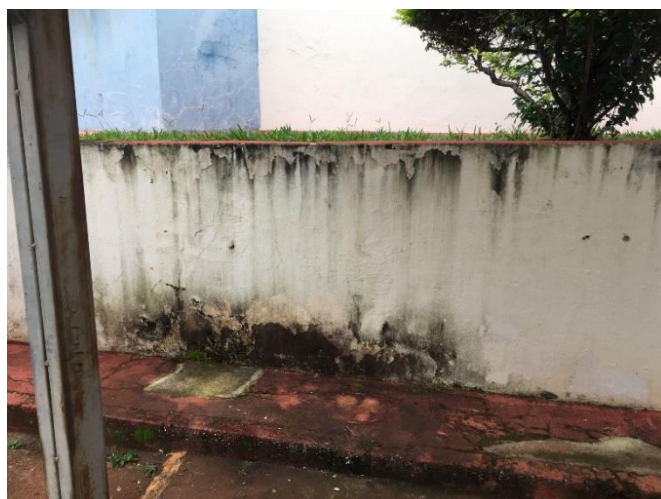
Figura 44 - Mofo no muro de arrimo
