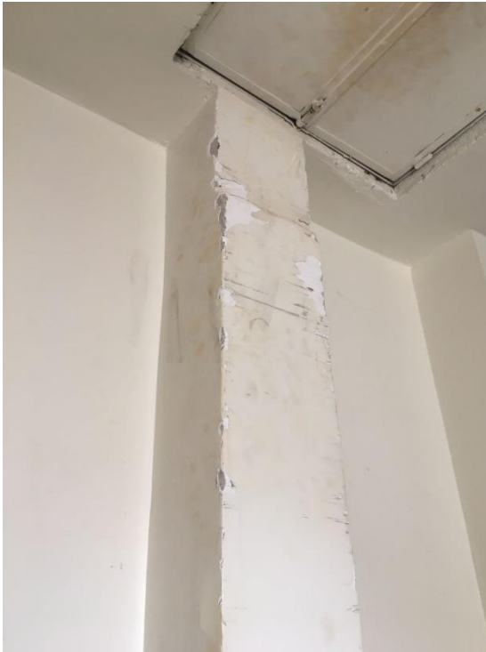
Figura 36 - Reboco e pintura danificada
