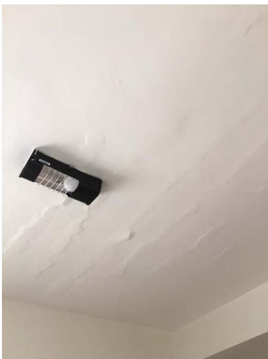
Figura 20 – Infiltrações na laje
