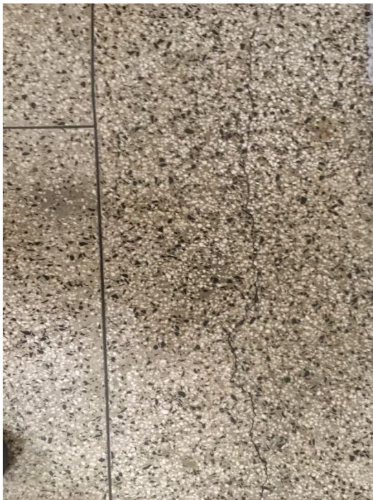
Figura 30 - Trincas no piso
