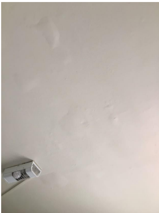
Figura 18 – Infiltrações na laje
