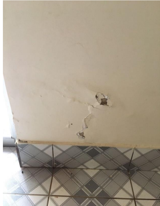
Figura 25 -Infiltração e Pintura danificada
