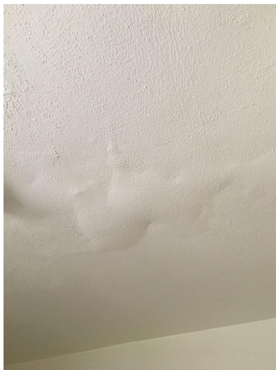
Figura 19 – Infiltrações na laje
