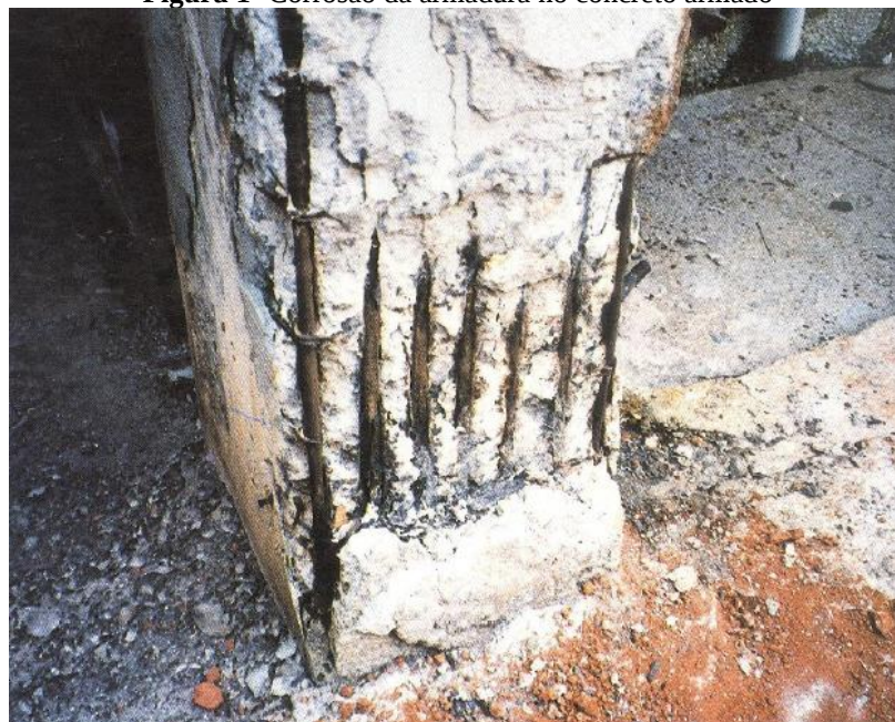
Figura 1- Corrosão da armadura no concreto armado
