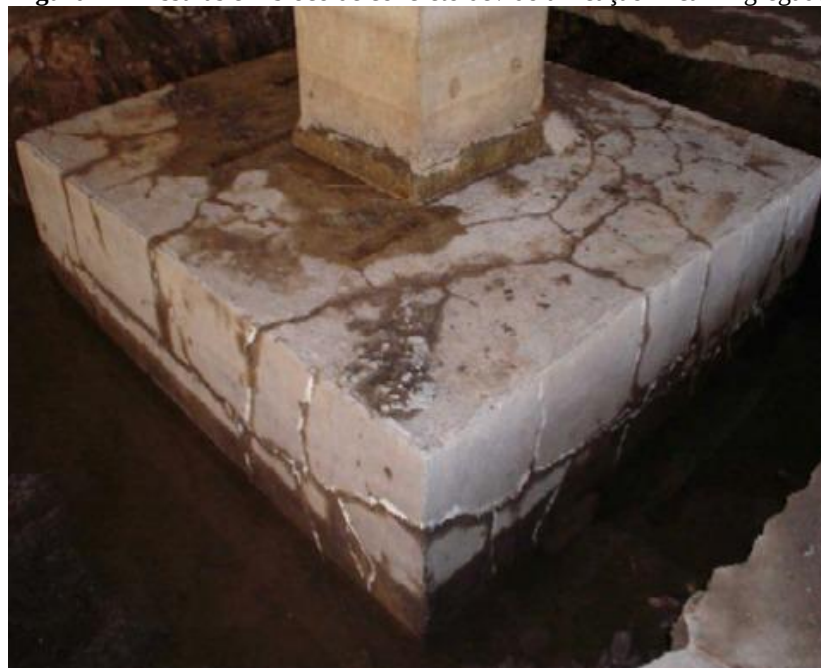
Figura 2 - Fissuras em bloco de concreto devido a Reação Álcali-Agregado
