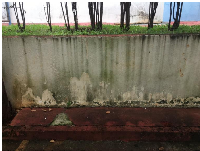
Figura 42 - Mofo no muro de arrimo
