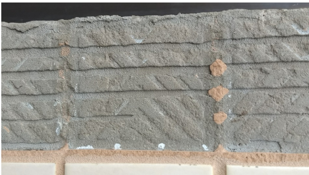
Figura 30 – Cordões de argamassa colante região F de descolamento
