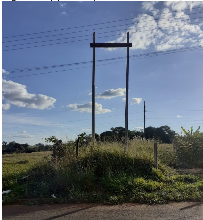
Figura 48 – Equipamento implantado no imóvel 01 – Grupo 02.
