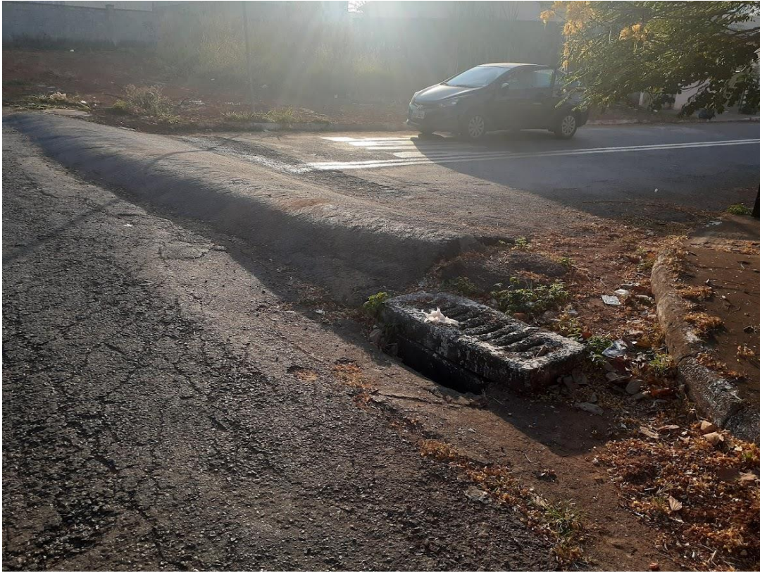
Figura 35 - quebra mola e boca de lobo que foram instalados de forma improvisada para aumentar a captação de águas pluviais
