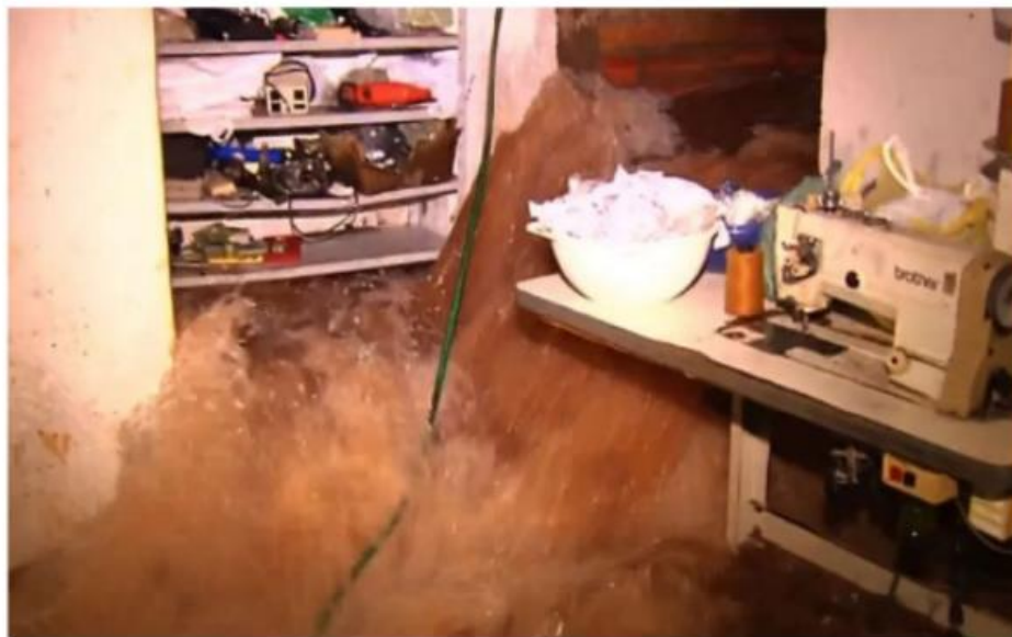
Figura 30- Residência invadida por água das chuvas no setor Residencial Itamaracá
