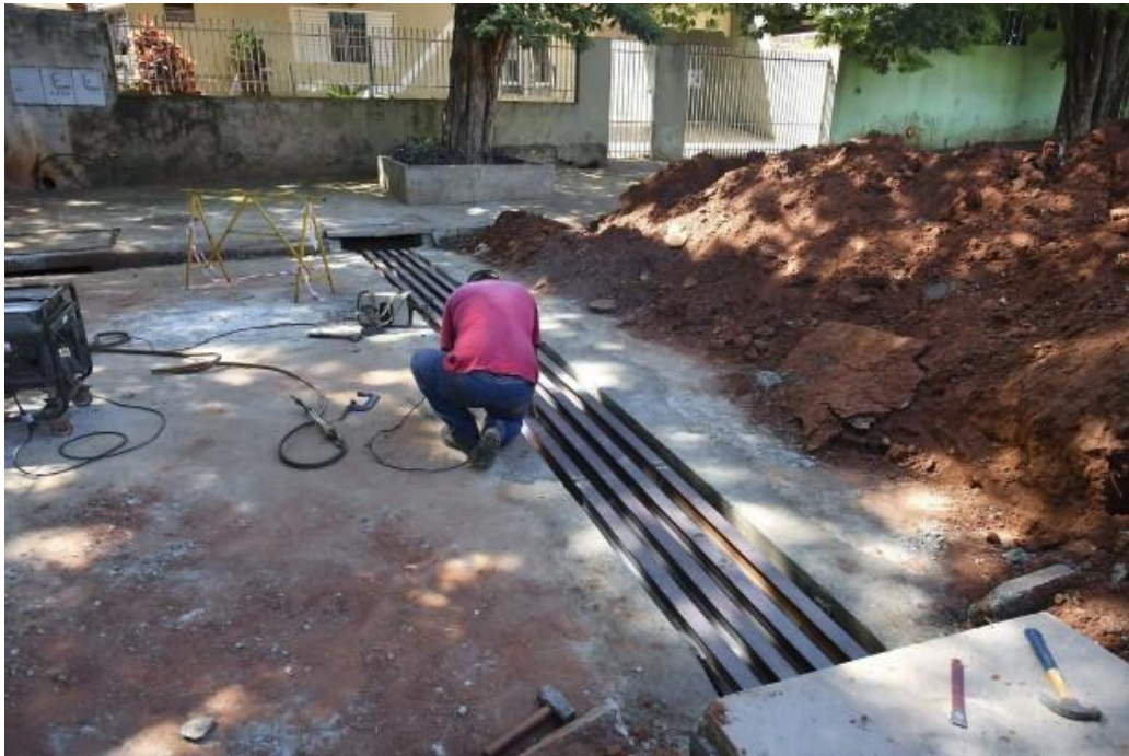
Figura 38- Exemplo de uma grelha de bocas de lobo
