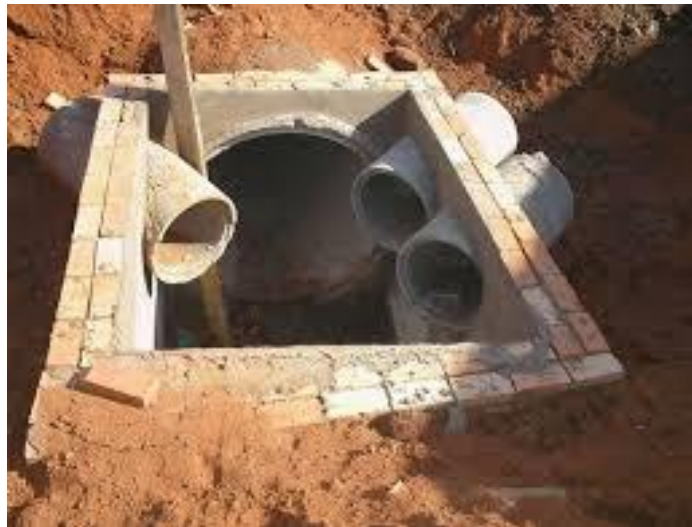
Figura 11- Exemplo de caixa de passagem
