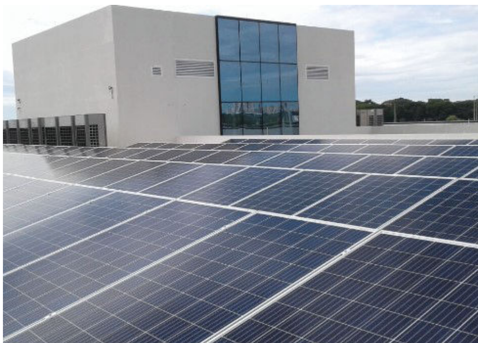
Figura 28: Sistema de placas fotovoltaicas na Sede Administrativa da Piracanjuba
