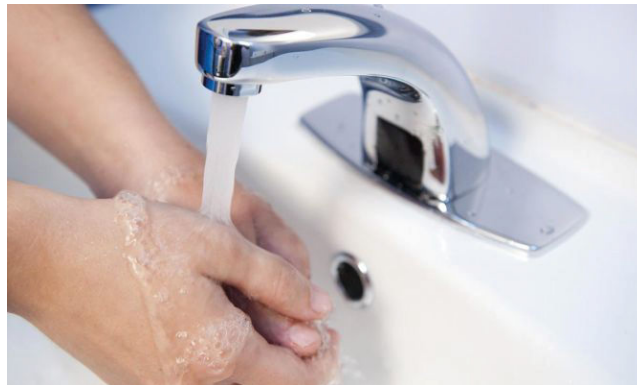
Figura 11: Torneira com sensor de presença
