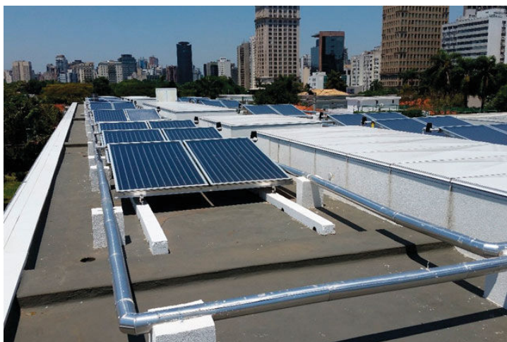
Figura 2: Sistema de aquecimento solar na cobertura de um prédio
