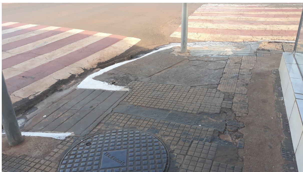
Figura 4.1.8: Material da superfície da calçada em condições desgastadas em frente ao rebaixamento.
