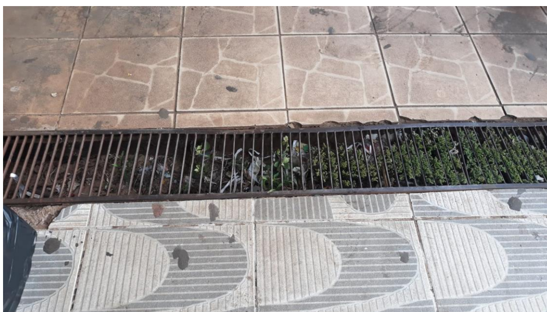
Figura 4.1.2: Grelhas com dimensões superiores ao permitido no trecho 2B.
