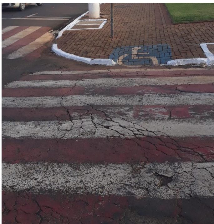
Figura: 4.1.12: Fotografia do estado de conservação da superfície da rua no trecho 2A e 3A.
