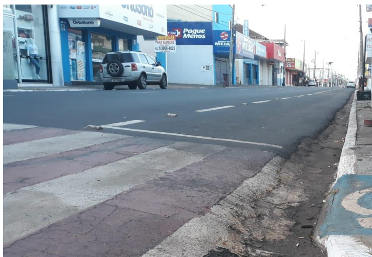
Figura 4.1.11: Fotografia do estado de conservação da superfície da rua.
