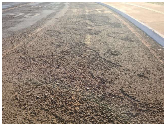
Figura 16 - Piso irregular e ausência de pintura vermelha
