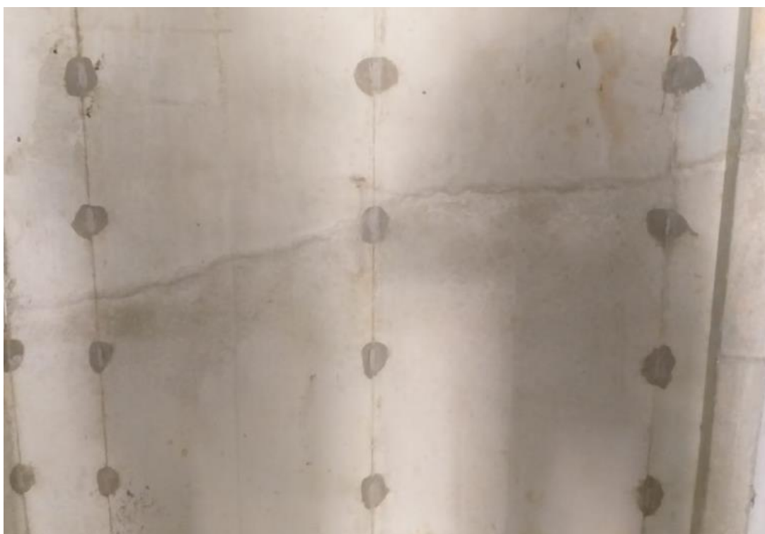
Figura 2.9.5 – Junta fria de concretagem em parede
