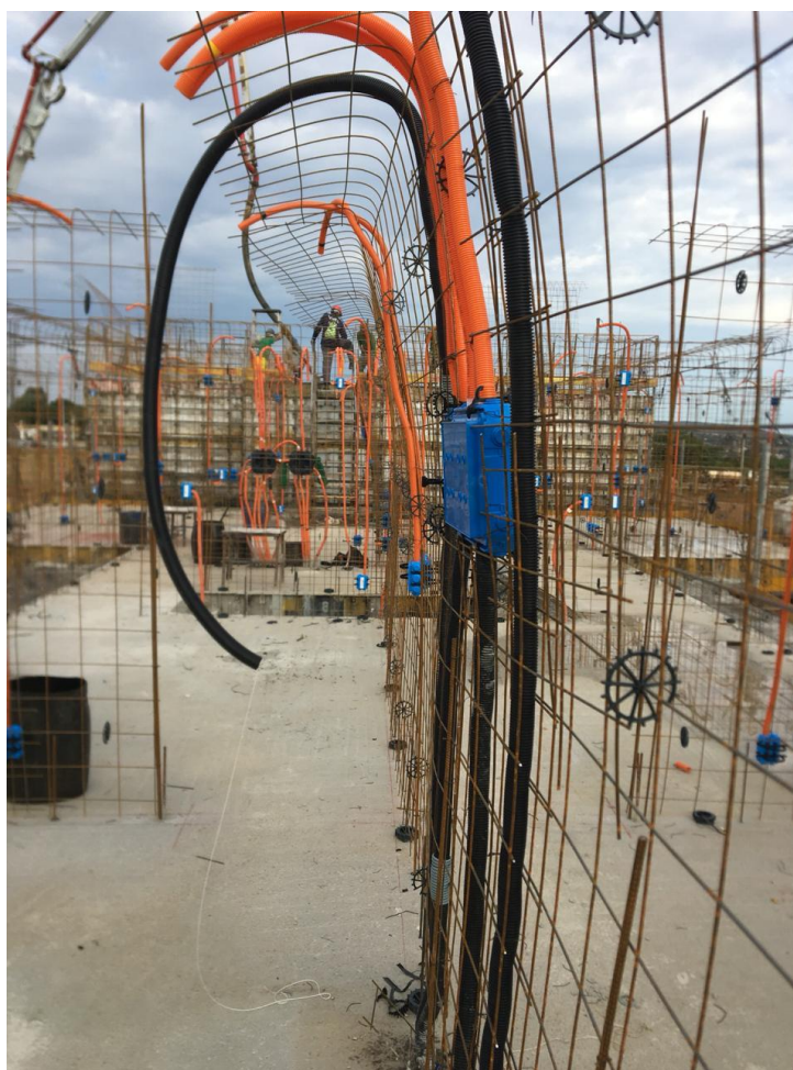
Figura 2.5.7.1 – Instalações elétricas em parede
