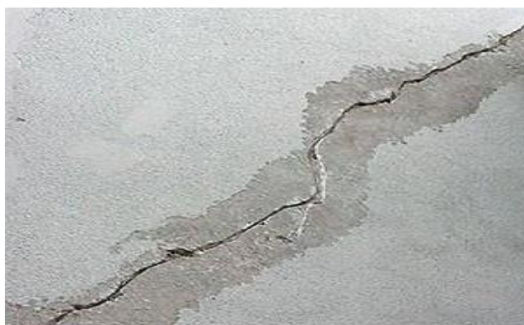
Figura 2.9.2 – Trinca em piso
