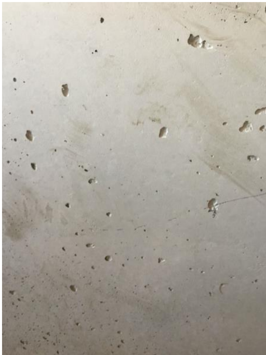
Figura 4.4.5.2 – Bolhas na superfície do concreto
