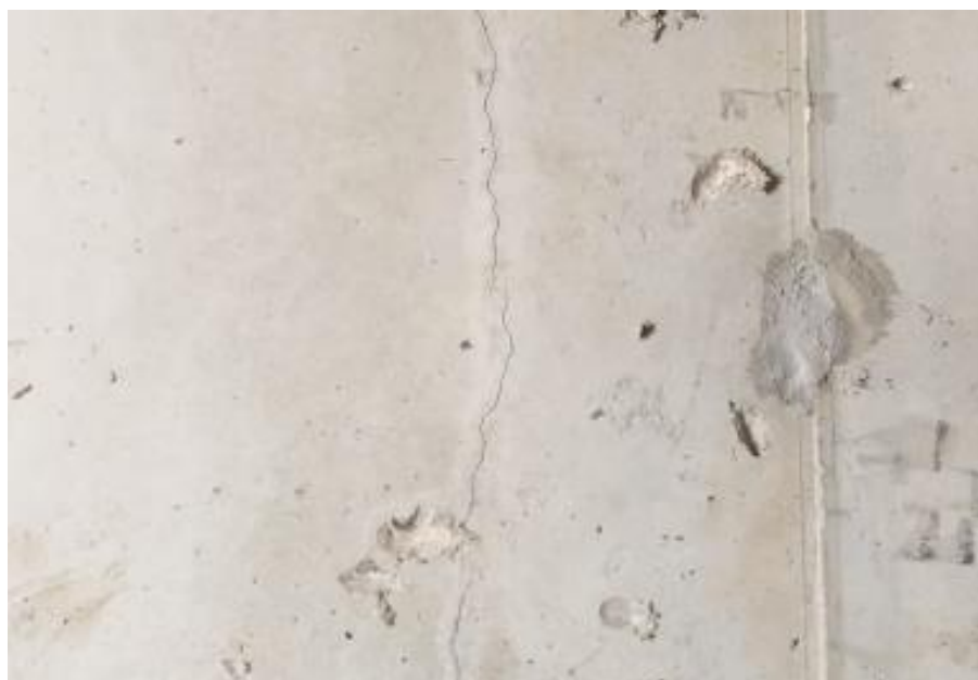
Figura 2.9.1 – Fissura em parede
