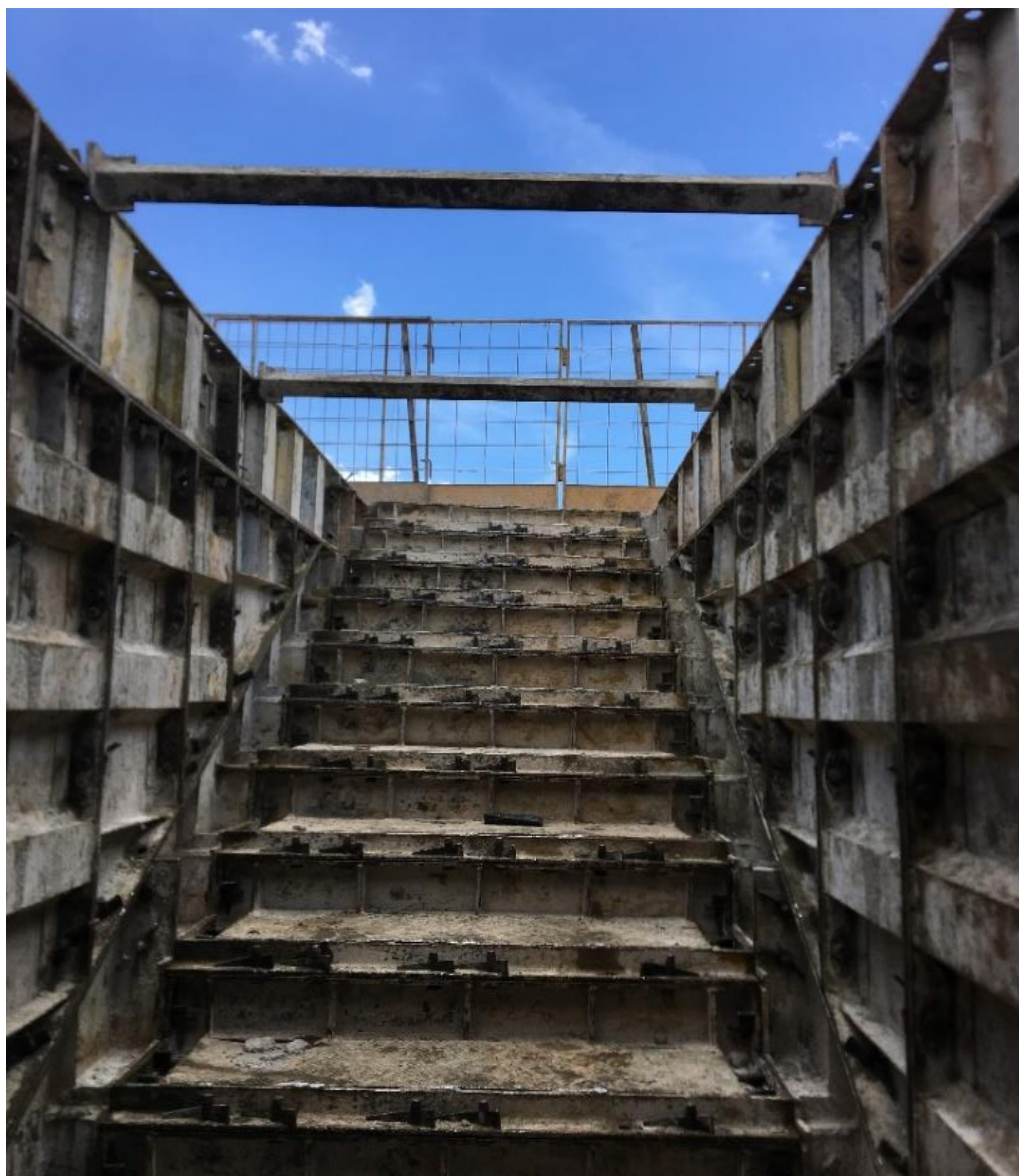
Figura 4.2.2.8 – Travamento da escada
