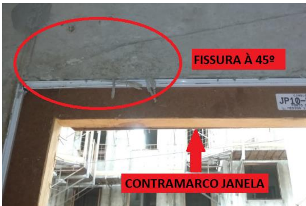
Figura 4.4.1.1 – Fissura à 45° em janela
