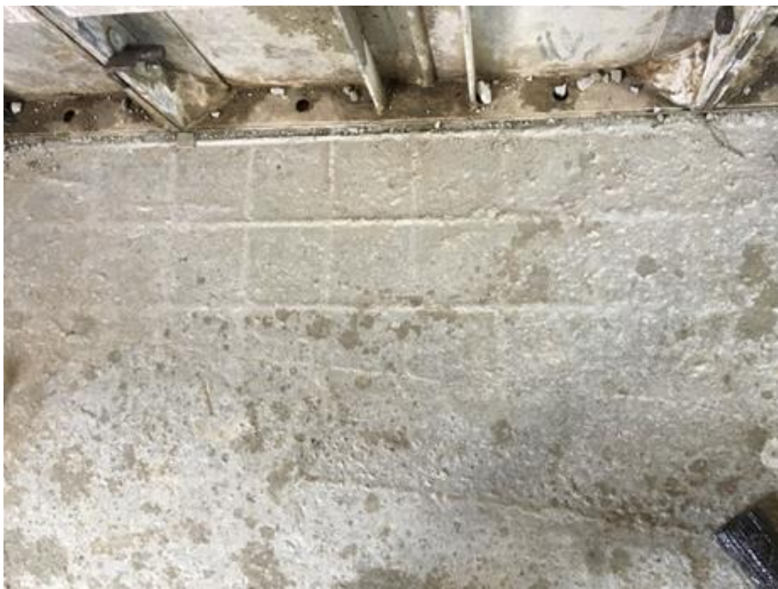
Figura 2.9.4 – Armadura exposta em piso
