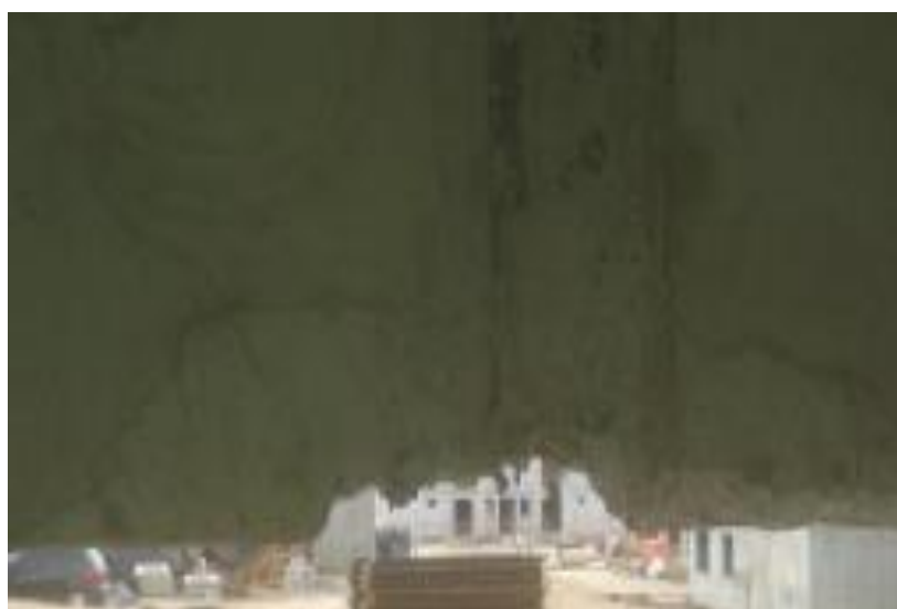
Figura 2.9.3 – Vazio de concretagem abaixo da abertura de uma janela
