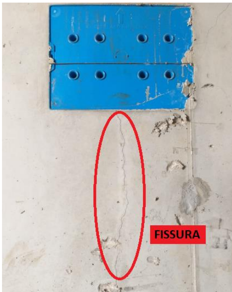
Figura 4.4.2.5 – Trinca abaixo do quadro de distribuição
