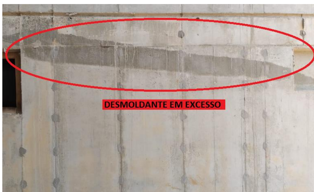
Figura 4.4.3.1 – Aplicação em excesso de desmoldante
