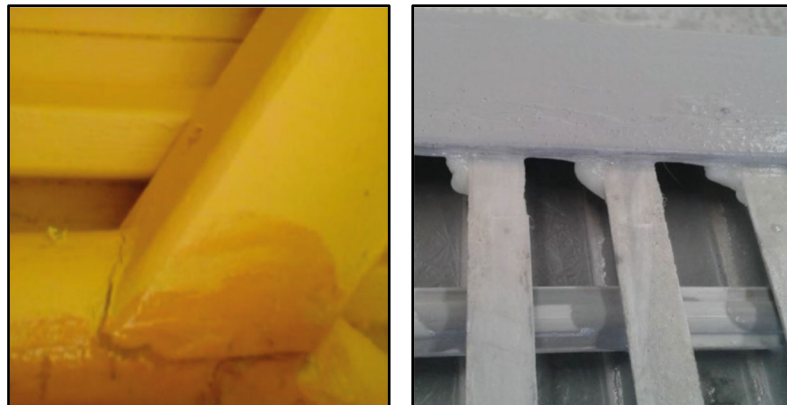
Figura 14 – Defeitos de acabamentos
