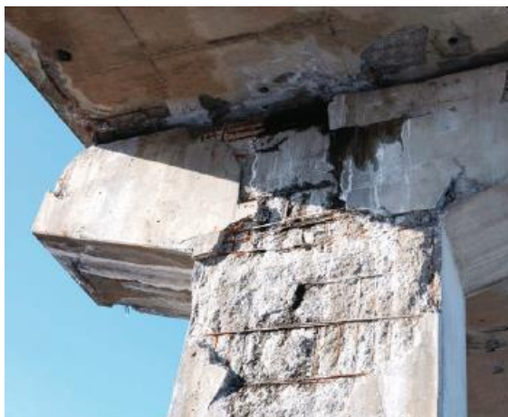
Figura 18 – Desagregação do concreto em pilar.
