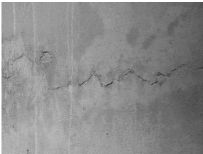
Figura 16 – Fissuras em pilar de concreto do Viaduto Cabral, MG.
