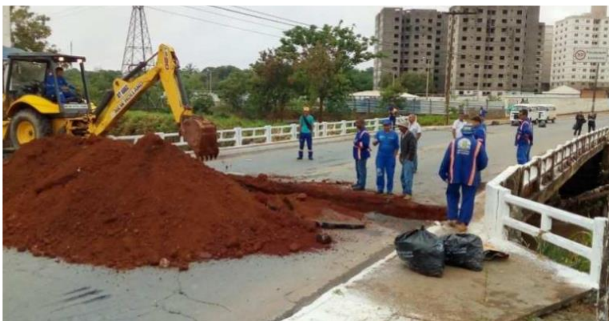
Figura 12 - Interdição da ponte sobre o córrego Anicuns devido a erosão.
