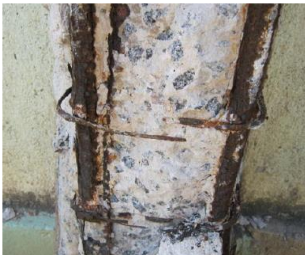
Figura 17 – Corrosão de armaduras.
