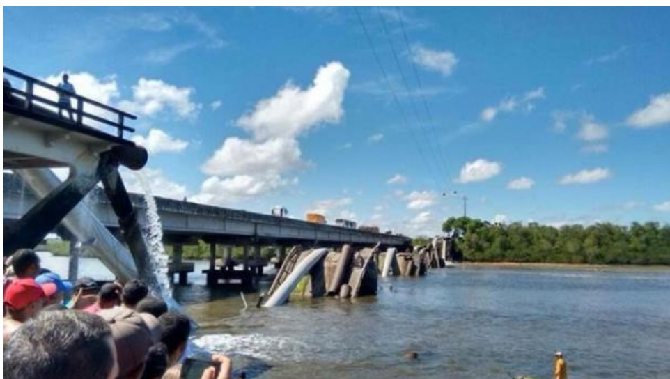
Figura 3 - Desabamento de ponte sobre a represa Capivari (BR-116).
