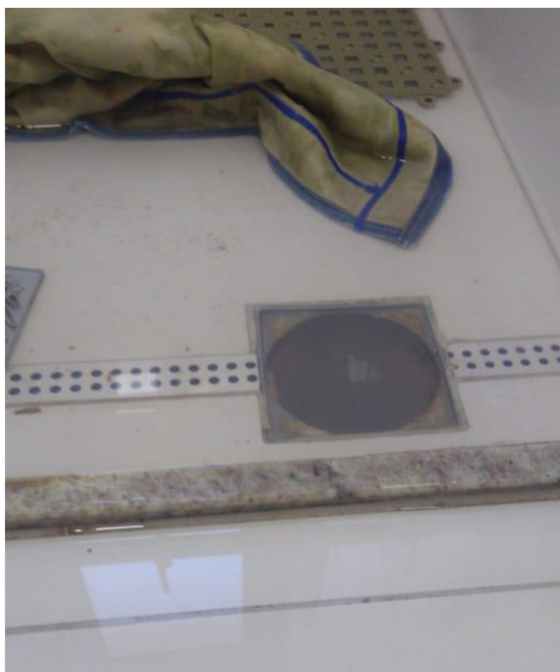
Figura 4.9 – Entupimento causado por restos de materiais de construção
