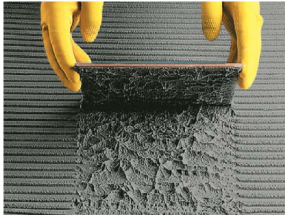
Figura 2.1 – Exemplificação dos cordões de argamassa defeitos promovendo impregnação da peça
