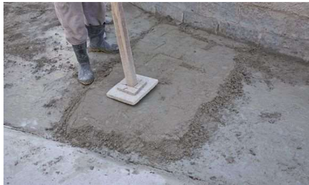
Figura 1.3 – Exemplificação do aspecto seco e heterogêneo da argamassa de contrapiso convencional.
