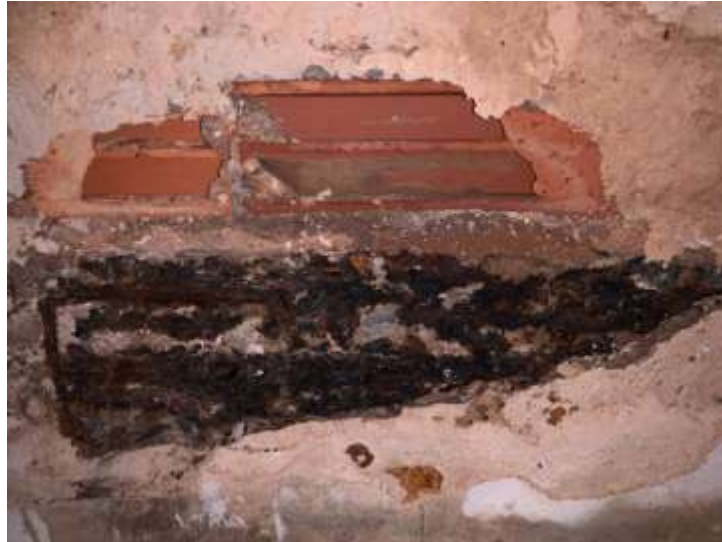
Figura 4.4 - Carbonatação e corrosão do aço.
