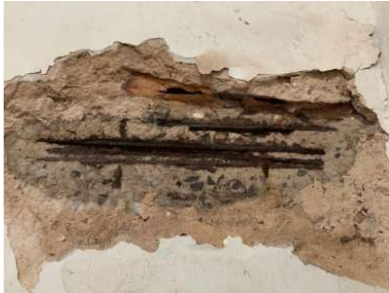
Figura 4.6 - Efeitos da corrosão do aço.
