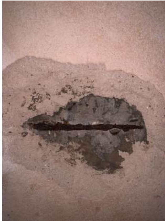
Figura 4.2 - Desplacamento do reboco.
