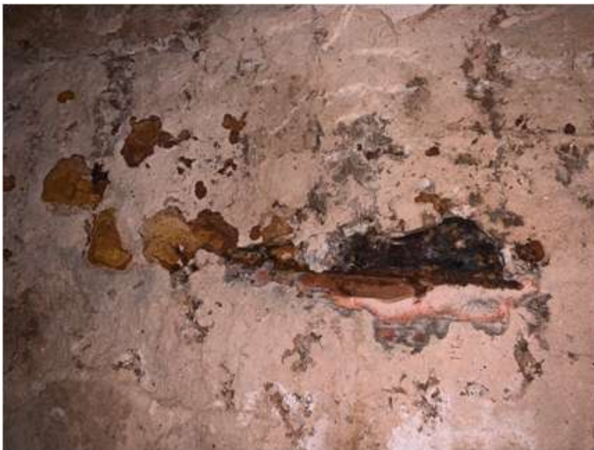
Figura 4.8 - Patologias sob o concreto.
