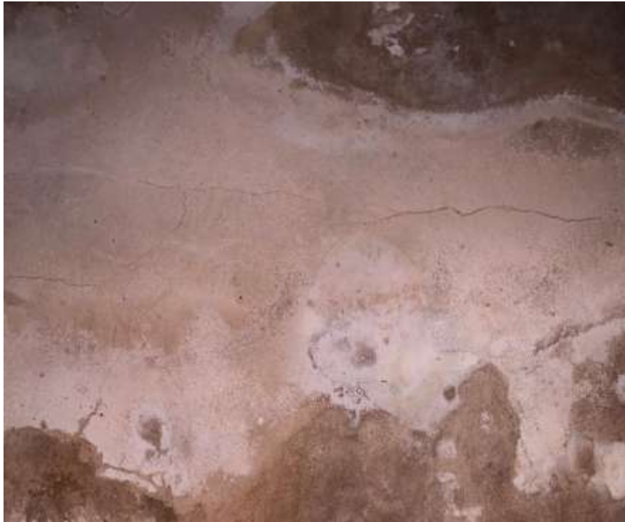
Figura 4.1 - Fissuras horizontais e verticais
