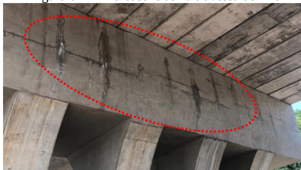
Figura 62 – Eflorescências na travessa do P40
