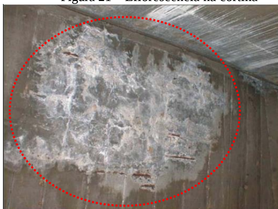
Figura 21 – Eflorescência na cortina
