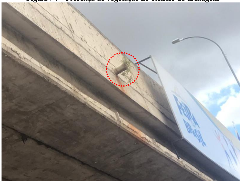
Figura 74 – Presença de vegetação no orifício de drenagem
