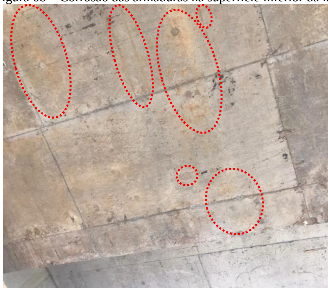
Figura 68 – Corrosão das armaduras na superfície inferior da laje
