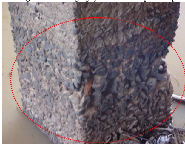
Figura 20 – Desagregação na base do pilar da ponte
