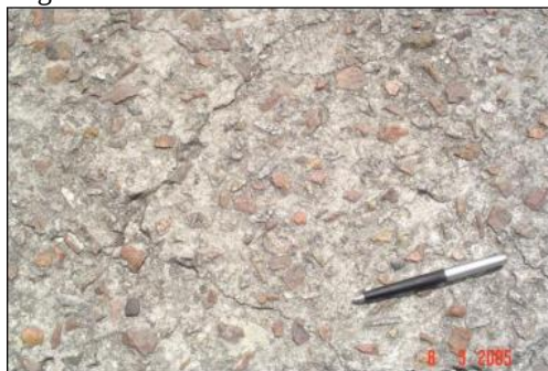
Figura 18 – Abrasão em estrutura de concreto
