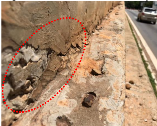
Figura 57 – Destacamento no muro de contenção
