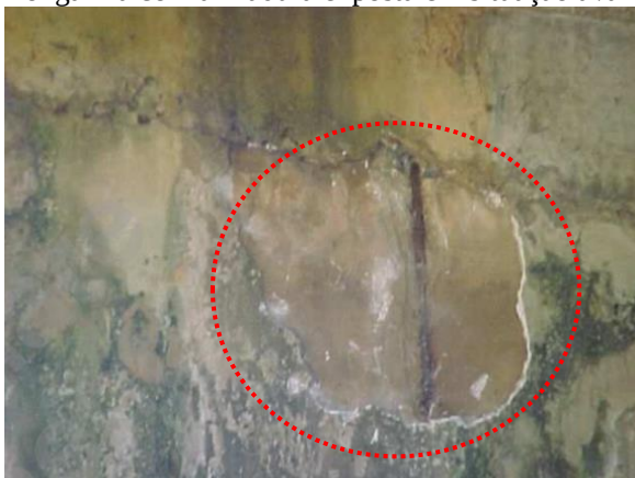
Figura 19 – Longarina com armadura exposta em situação avançada de corrosão
