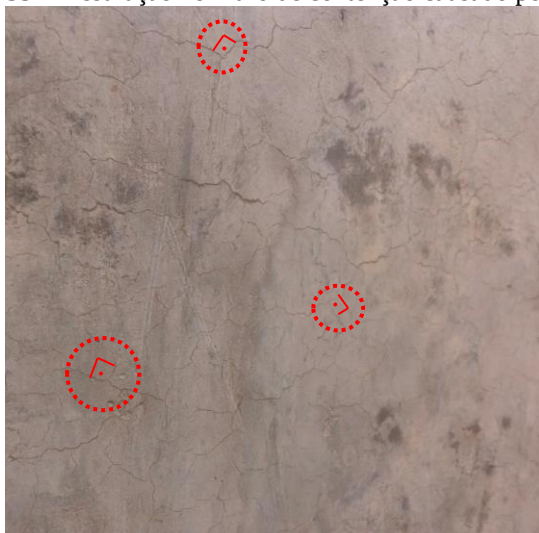
Figura 55 – Fissuração no muro de contenção causado por retração
