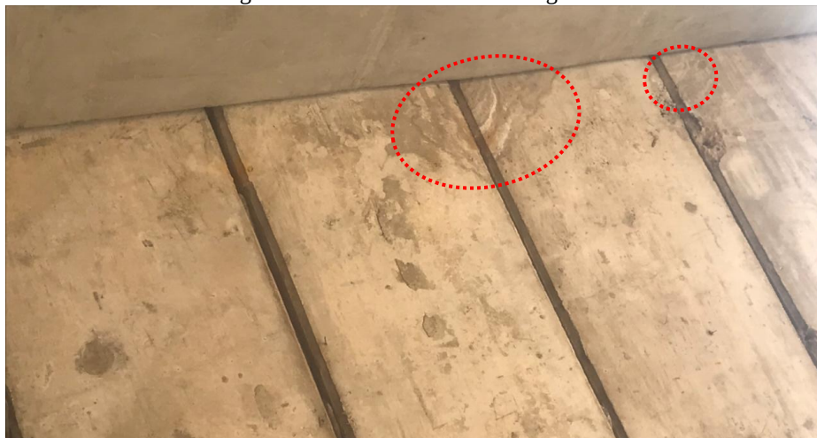
Figura 65 – Eflorescências nas longarinas
