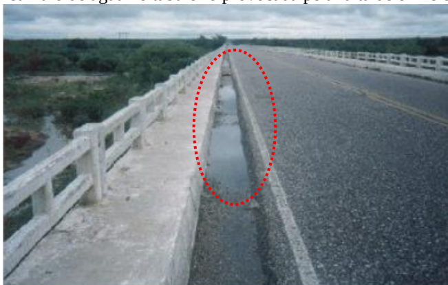
Figura 23 – Acúmulo de água no tabuleiro provocada pela falta de orifício de drenagem
