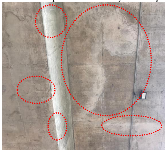
Figura 67 – Eflorescências na superfície inferior da laje em balanço e da seção caixão
