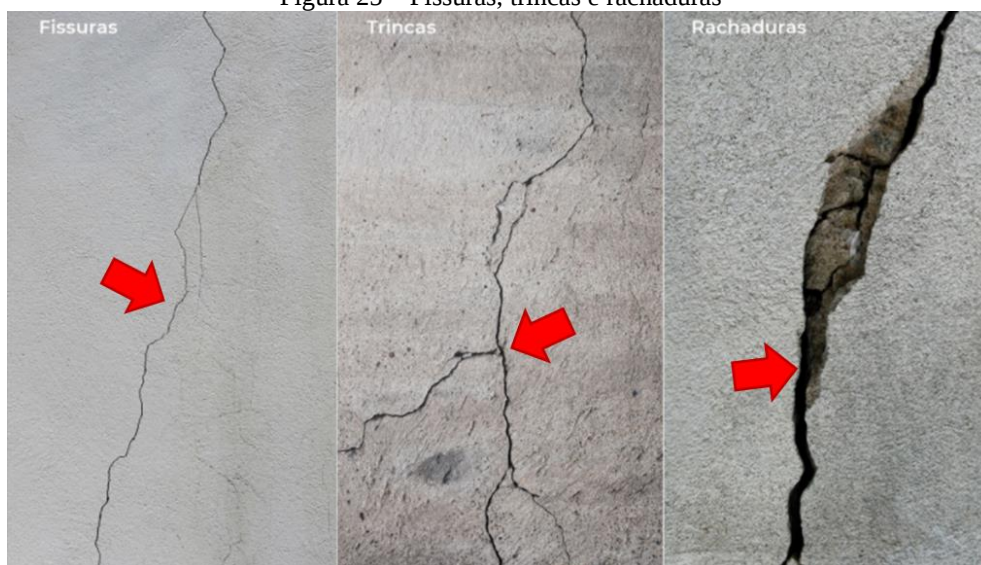
Figura 25 – Fissuras, trincas e rachaduras
