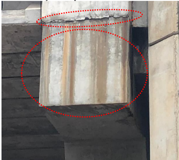
Figura 64 – Fissuração no topo da travessa e manchas avermelhadas
