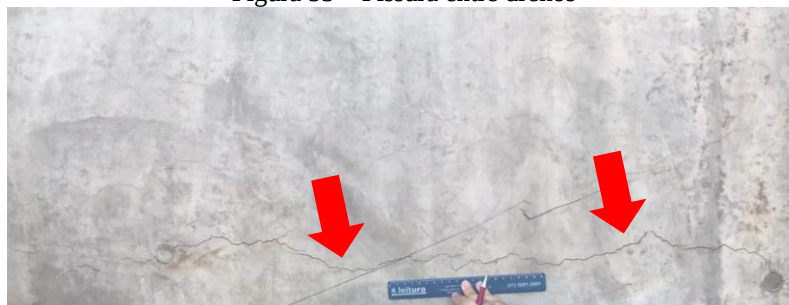
Figura 53 – Fissura entre drenos
