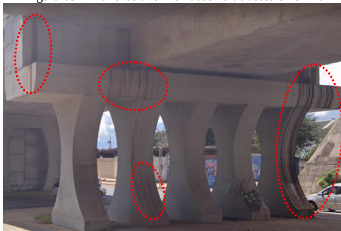
Figura 63 – Manchas avermelhadas na travessa e no P40
