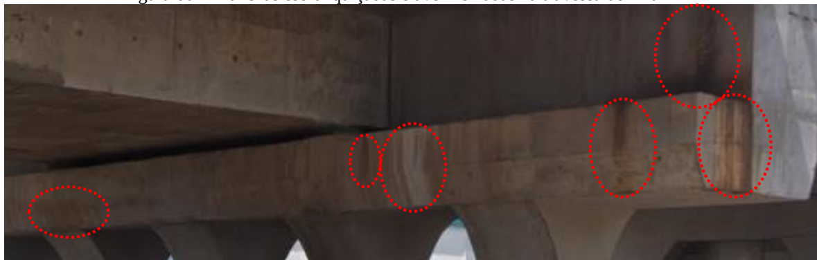
Figura 60 – Manchas esbranquiçadas e avermelhadas na travessa do P20
