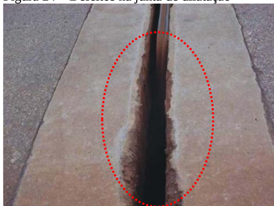
Figura 24 – Defeitos na junta de dilatação
