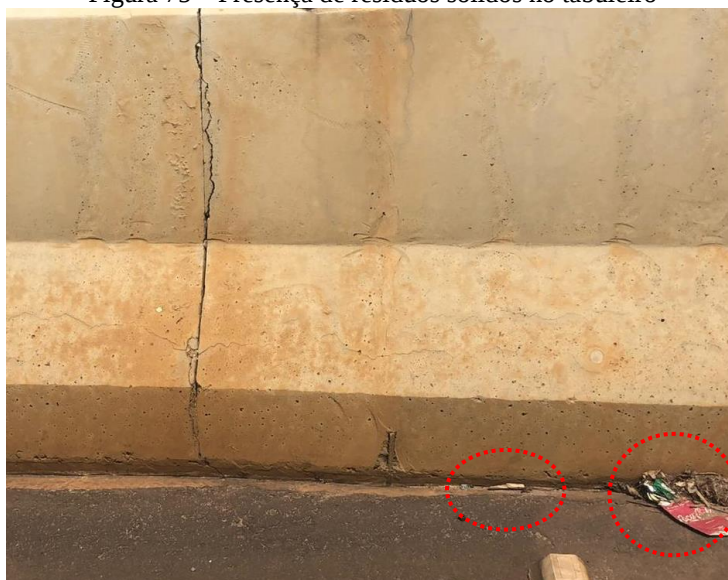
Figura 75 – Presença de resíduos sólidos no tabuleiro
