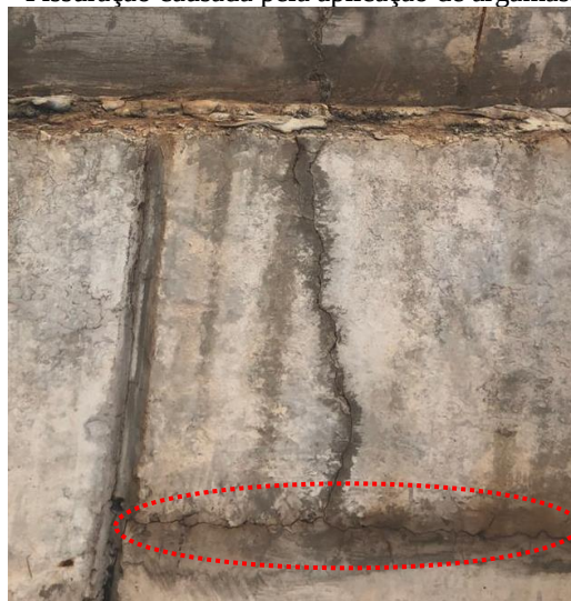
Figura 56 – Fissuração causada pela aplicação de argamassa na abertura
