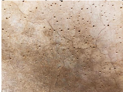
Figura 58 – Presença de pites no muro de contenção
