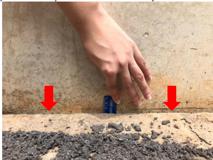
Figura 59 – Contração térmica da estrutura ou expansão térmica do piso
