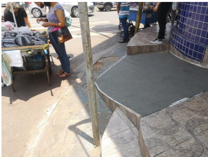
Figura 6.3 – Calçada danificada e com ausência de acessibilidade
