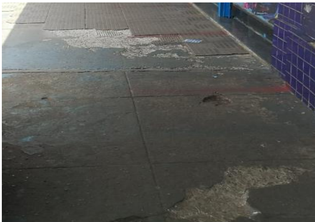
Figura 3.4 – Calçada em mal estado de conservação em Anápolis, Goiás
