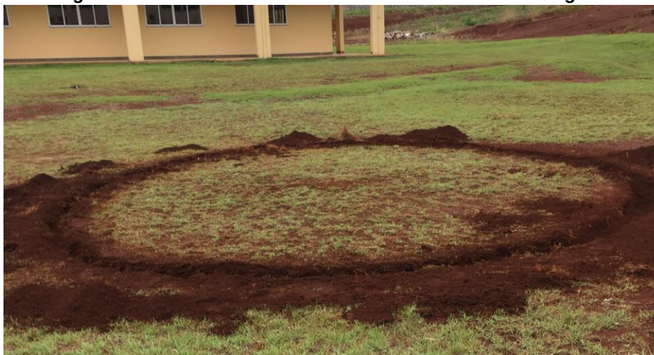
Figura 59: Malha de aterramento em circunferência visão geral
