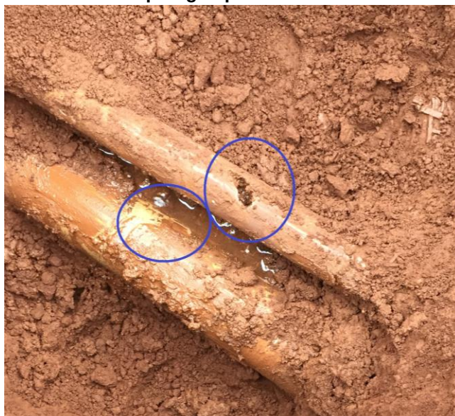
Figura 54: Cano danificado no momento da escavação de um dos buracos da haste na topologia quadrado vazio
