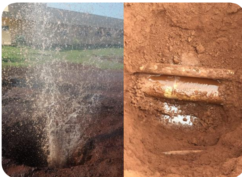
Figura 79 - Sistema de canalização danificado
