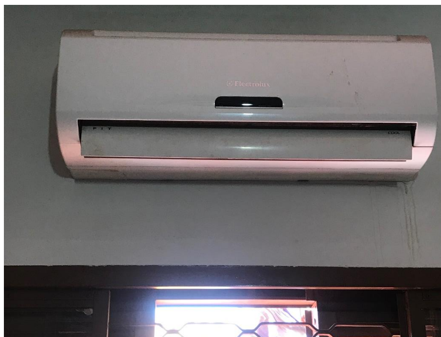
Figura 34 – Unidade Evaporadora do equipamento – Convencional. Fonte: Autoria Própria
