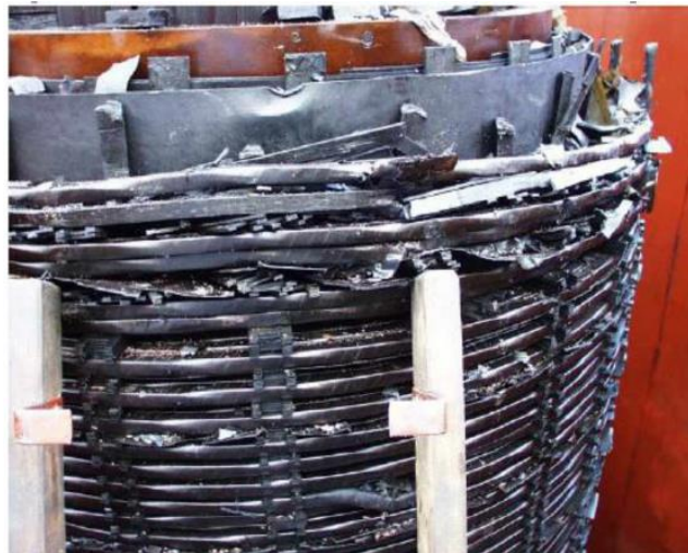
Figura 18 – Colapso axial correspondente a uma força axial excessiva causada por um curto-circuito em um transformador.
