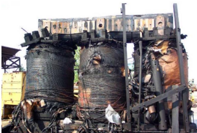
Figura 1 – Transformador danificado após ocorrência de uma falha.
