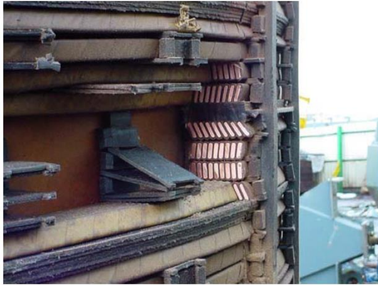
Figura 22 – Problema de tombamento ( tilting ) em um transformador.
