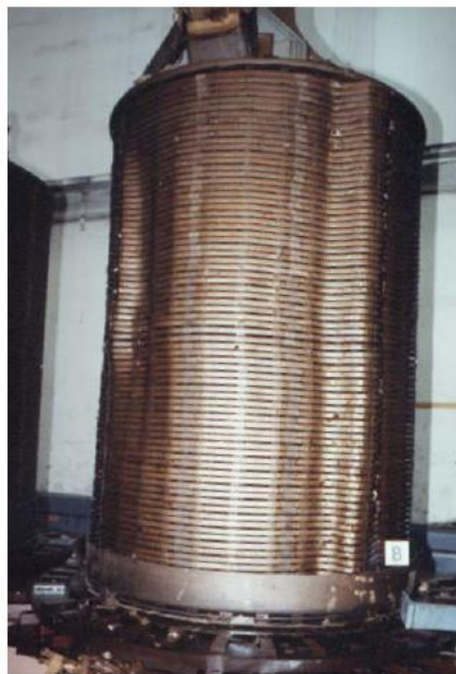
Figura 14 – Deformação forçada ( forced buckling ) no enrolamento de um transformador.
