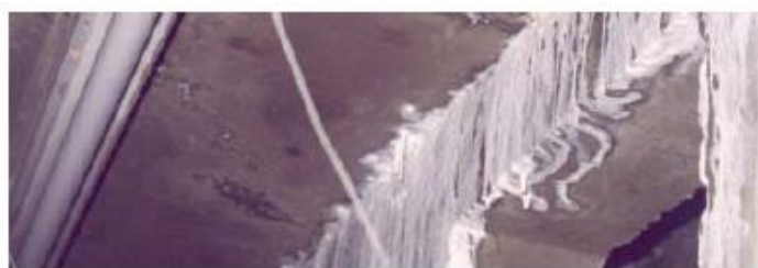
Figura 10 - Manifestação causando descolamento da pintura
