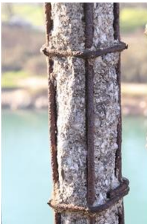
Figura 7 - Corrosão em armaduras
