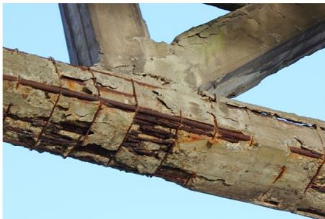
Figura 8 - Viga com a exposição da armadura e com o processo de corrosão iniciado
