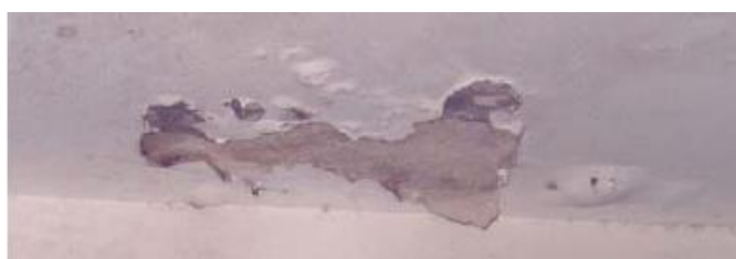
Figura 9 - Eflorescências já com a formação de estalactites
