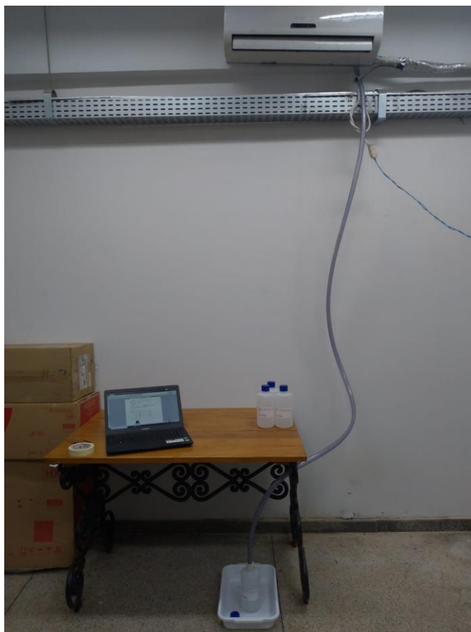
Figura 11 - Sistema de coleta mostrando o Ar Condicionado - modelo Split.
