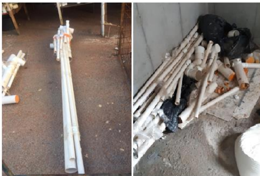
Figura 55: Diferenciação entre os kits de esgotos montados e o material danificado
