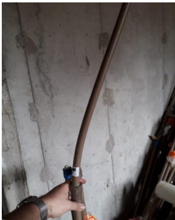
Figura 54: Tubulação deformada por conta do contato direto com o sol
