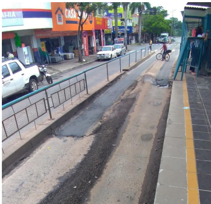
Figura 4.6 Estado de conservação do pavimento na Av. Anhanguera/Centro da Cidade de Goiânia.
