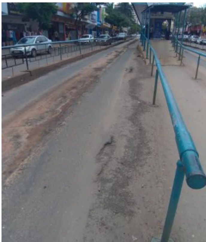
Figura 5.11- Patologias na Faixa Exclusiva da Av. Anhanguera
