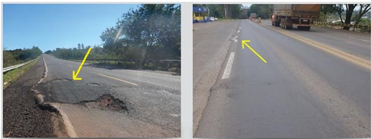
Figura 2.15 – Patologia Tipo “Escorregamento”
