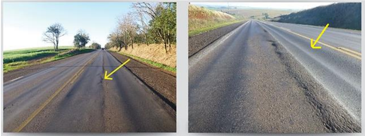
Figura 2.13 – Patologia Tipo “Deformação Permanente”
