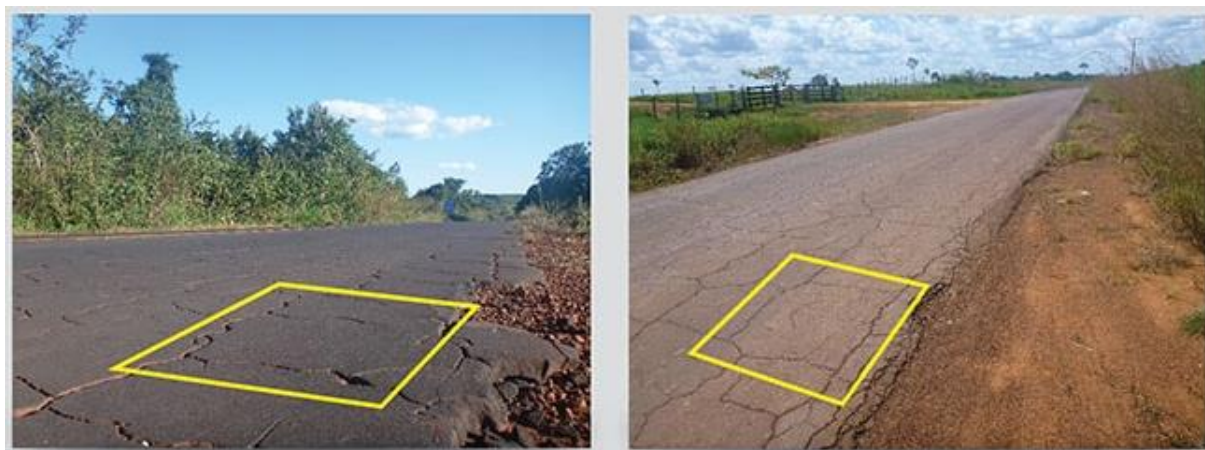
Figura 2.9 – Trincas Tipo “Bloco”
