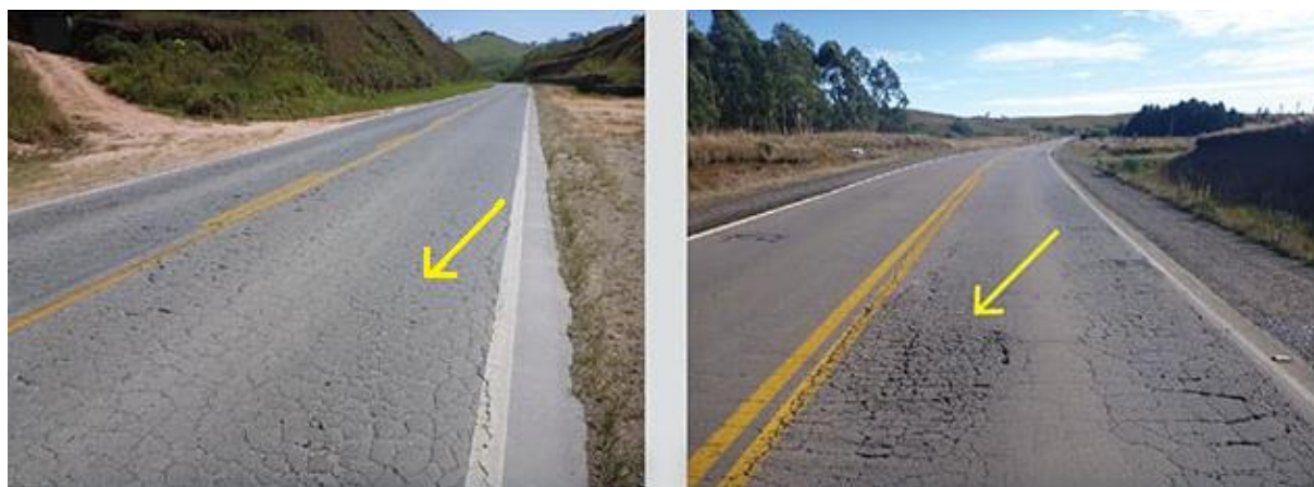
Figura 2.8 – Trincas Interligadas Tipo “ Couro de Jacaré”
