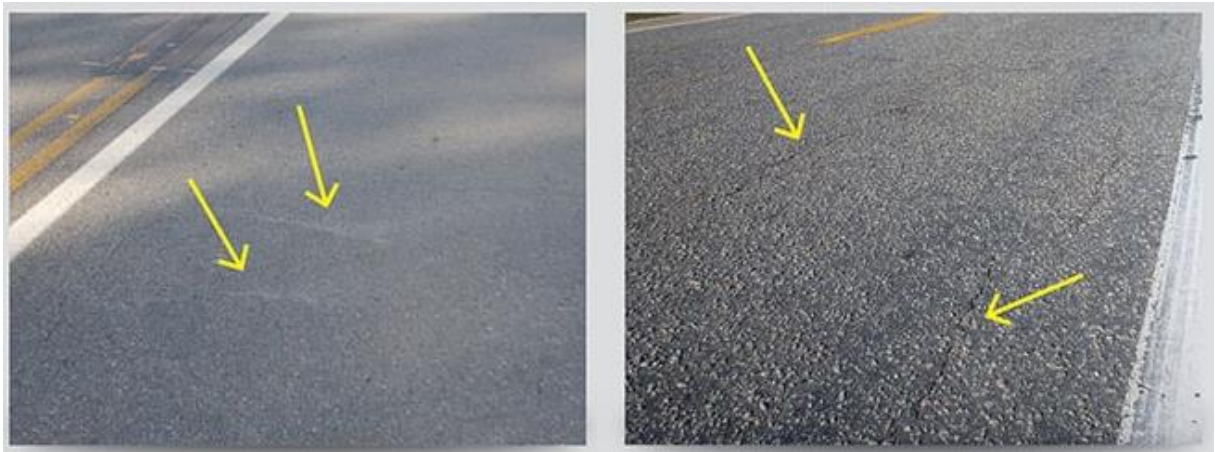
Figura 2.5 – Trincas no Pavimentos
