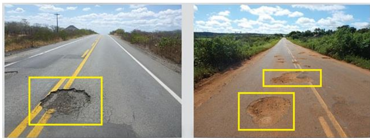
Figura 2.11 – Patologia Tipo “Buracos e Panelas”
