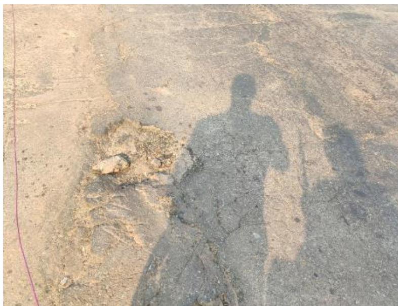
Figura 5.6 Remendo, Afundamento Plástico e Trincas Longitudinais e Transversais
