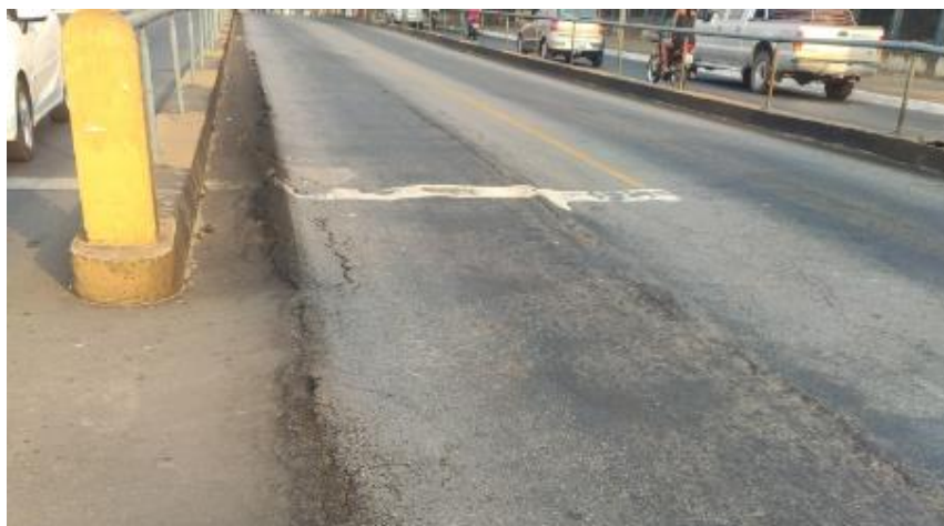
Figura 5.3 Afundamento de Consolidação
