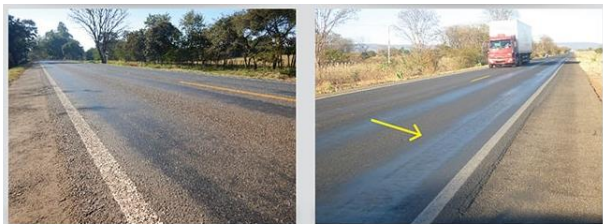
Figura 2.16 – Patologia Tipo “Escorregamento”
