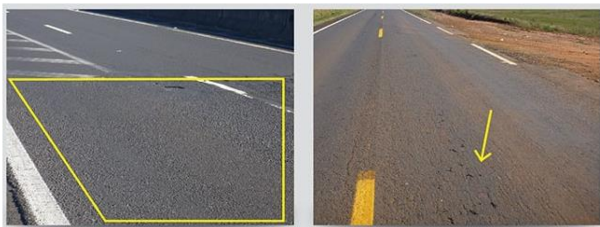
Figura 2.10 – Patologia Tipo “Desgaste”
