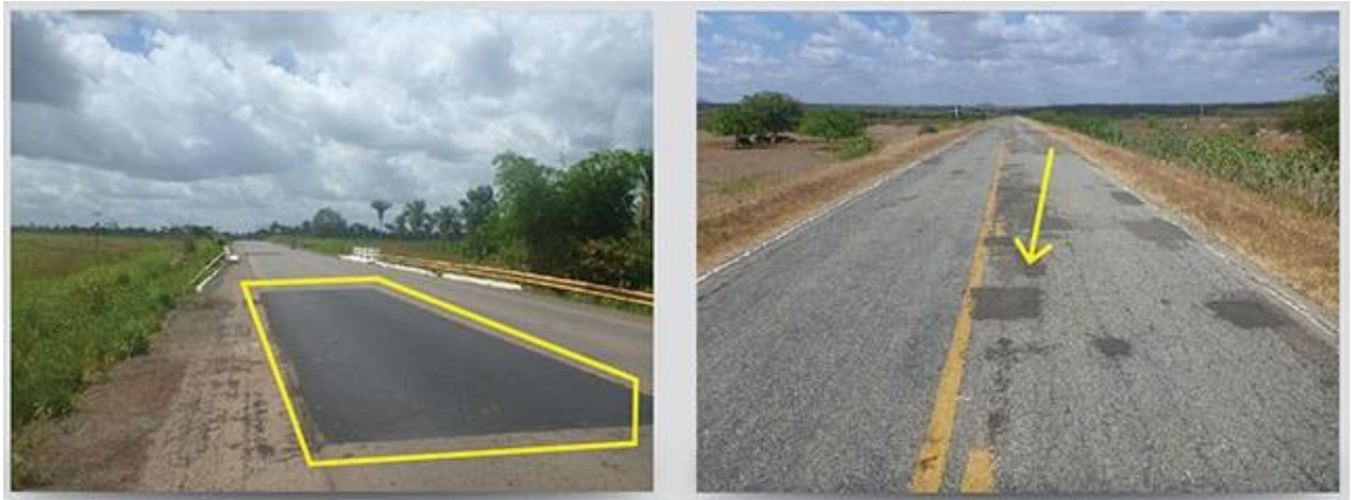
Figura 2.12 – Patologia Tipo “Remendo”
