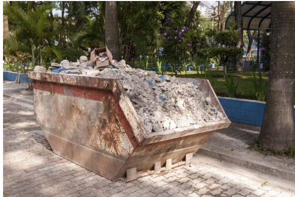
Figura 2.5 - Entulhos de Obras
