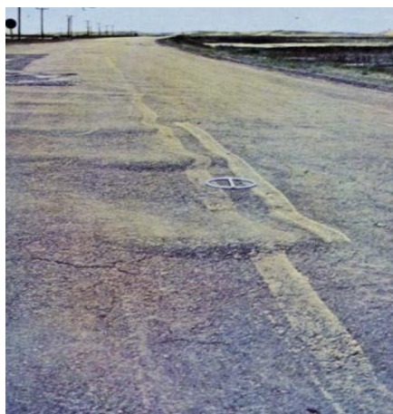
Figura 2.22: Corrugação ou Ondulação
