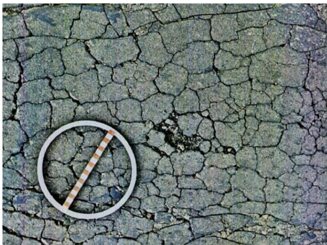
Figura 2.18: Trinca tipo “Couro de Jacaré”
