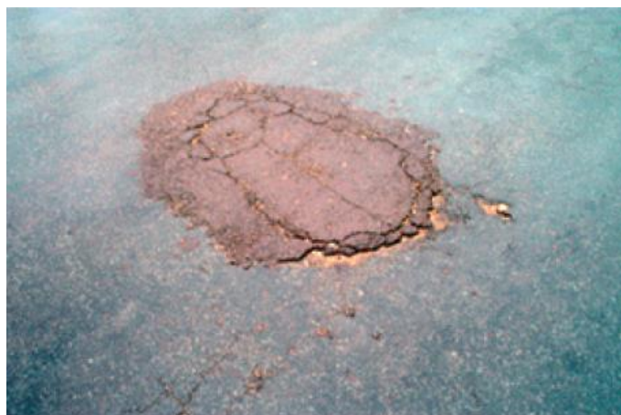
Figura 2.27: Remendo mal executado
