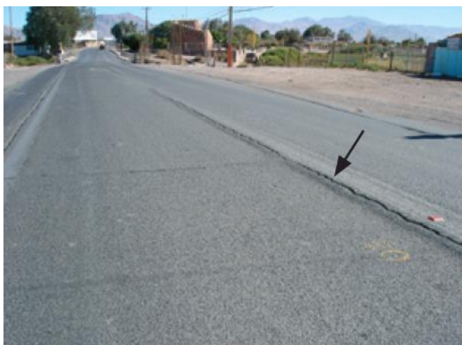
Figura 2.17: Trinca isolada de retração
