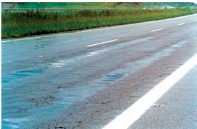
Figura 2.21: Afundamento por consolidação em trilha de roda
