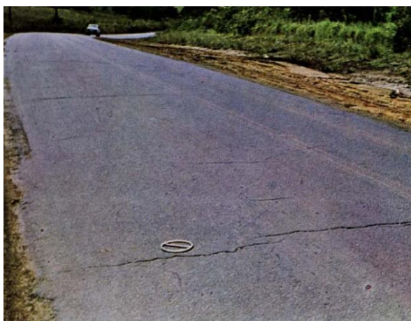
Figura 2.15: Trinca isolada transversal
