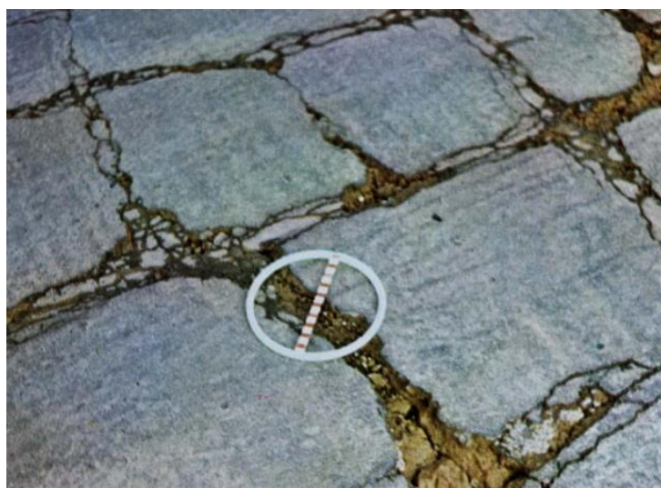
Figura 2.19: Trinca tipo “Bloco”
