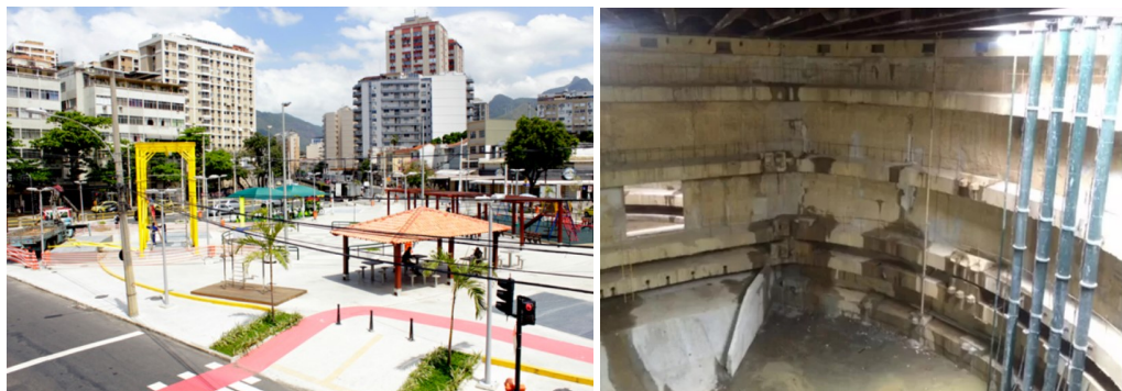
Figura 10a e 10b: Reservatório Praça Vanhargen.
