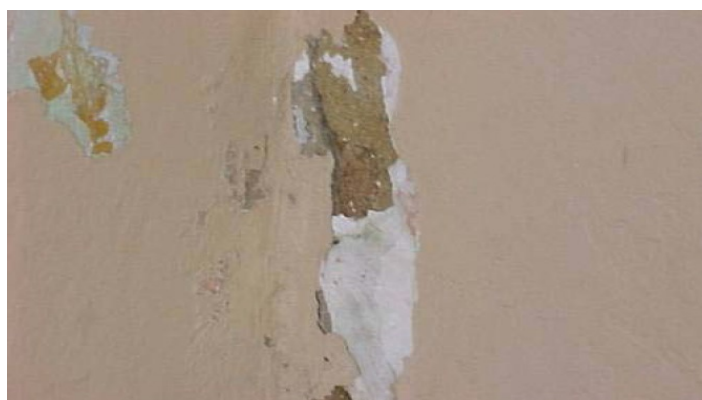
Figura 2.23 – Exemplo de destacamento de pintura
