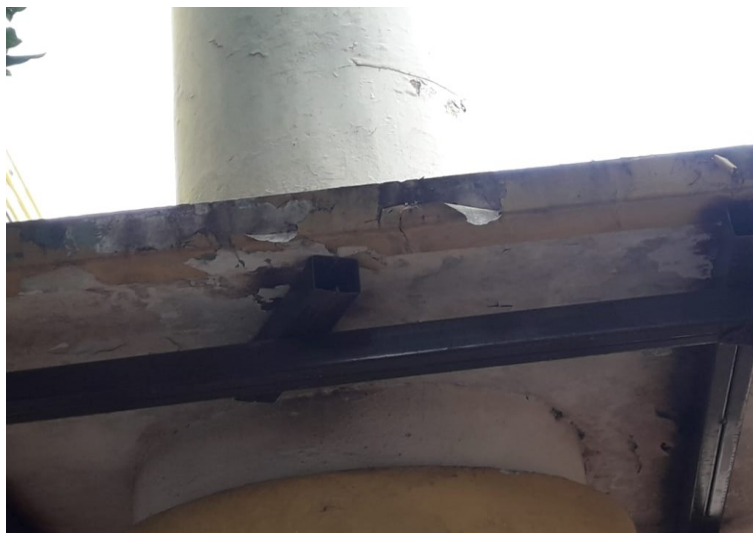
Figura 4.4 – Destacamento da pintura
