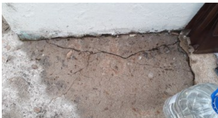
Figura 4.14 – Aspectos de fissuração do concreto da laje, em sua parte superior, em região entorno de um dos pilares
