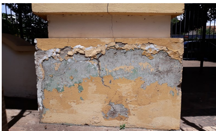
Figura 4.6 – Pilar com incidência de fissuras e descoloração da pintura
