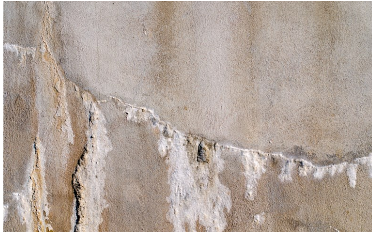
Figura 2.20 – Presença de eflorescência na superfície do concreto
