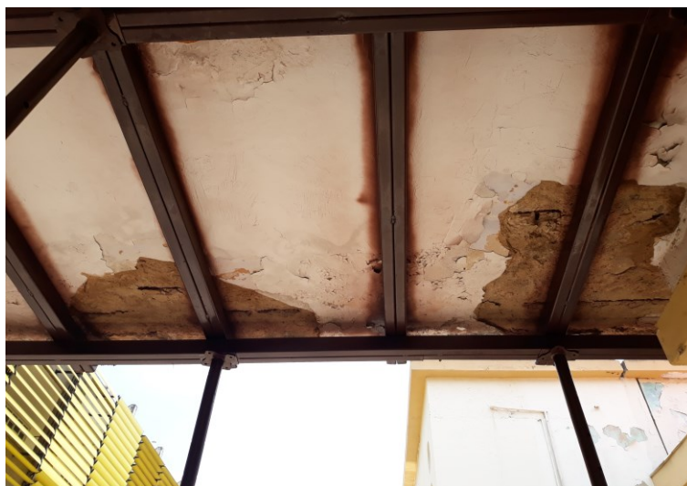
Figura 4.1 – Parte inferior da laje com destacamento de concreto
