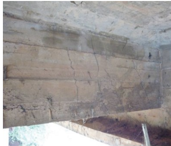
Figura 2.18 – Fissuras em ponte provocadas pela ação de sobrecargas
