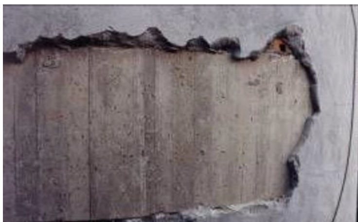
Figura 2.22 – Descolamento de argamassa em placa
