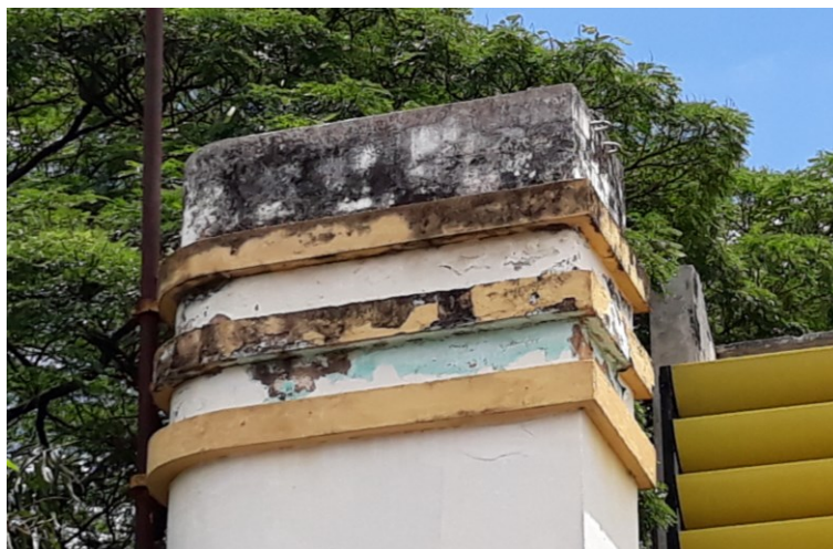
Figura 4.5 – Topo do pilar com presença de sujeira e destacamento da pintura
