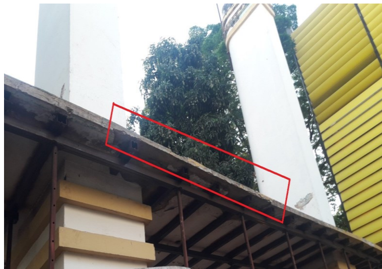
Figura 4.3 – Destacamento da borda da laje
