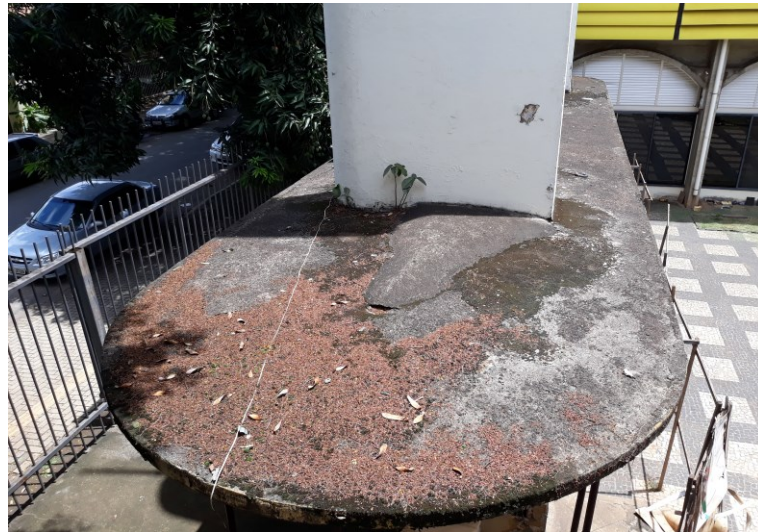
Figura 4.2 – Laje com presença de mofo e sujeira
