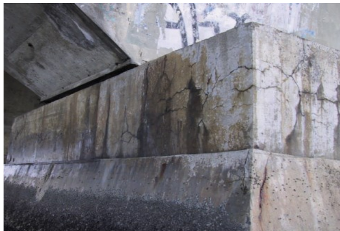
Figura 2.15 – Sinais de deterioração ocasionada pela reação álcali-agregado em uma ponte
