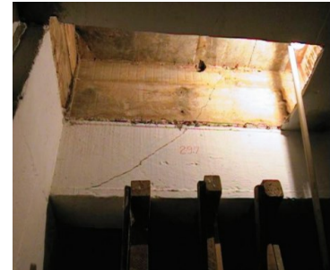
Figura 2.19 – Fissuras provocadas por recalque de fundação
