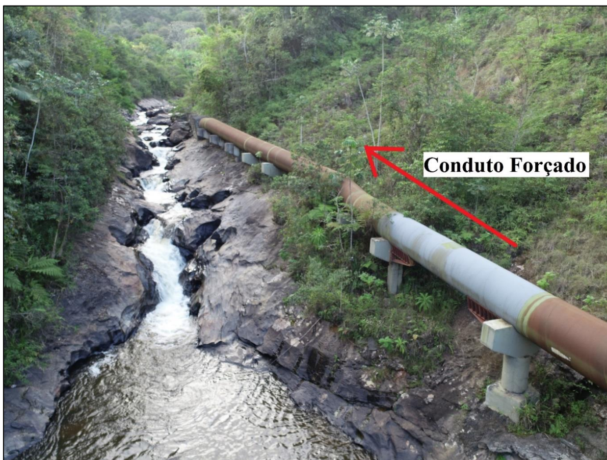
Figura 5 – Conduto de adução em operação da CGH MV, em Minas Gerais.
