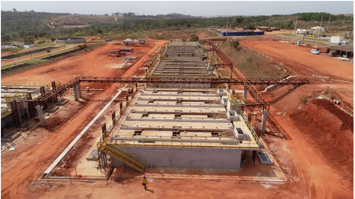
Figura 3 - Reator Anaeróbio de Fluxo Ascendente
