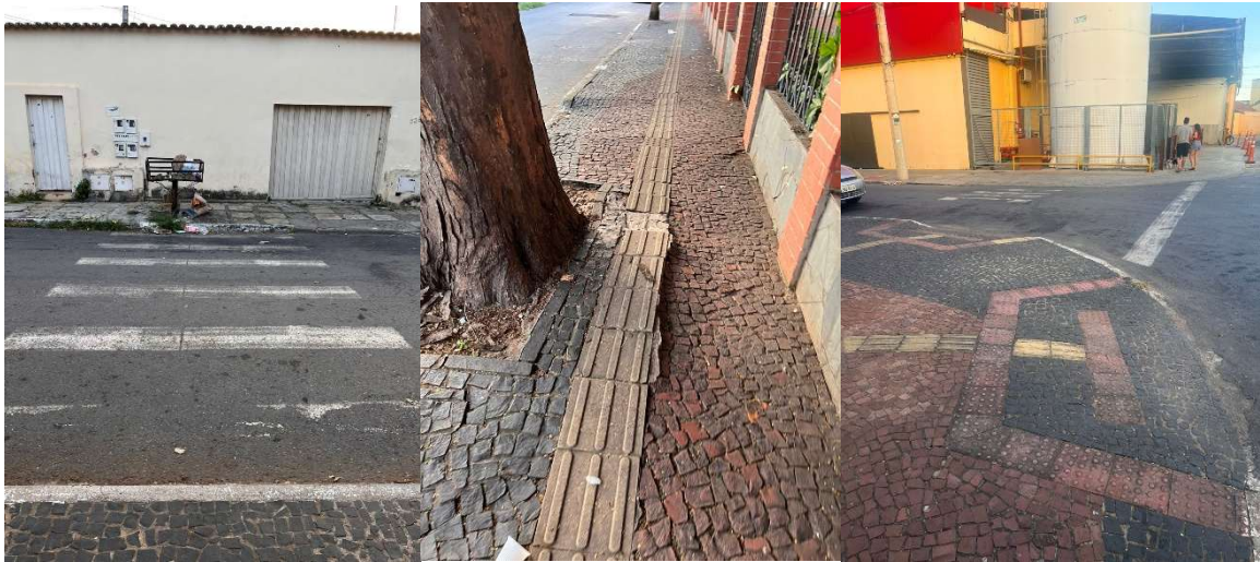
Figura 23 –Evidências do Bloco 4 - Acessibilidade na Rota da Avenida Paranaíba
