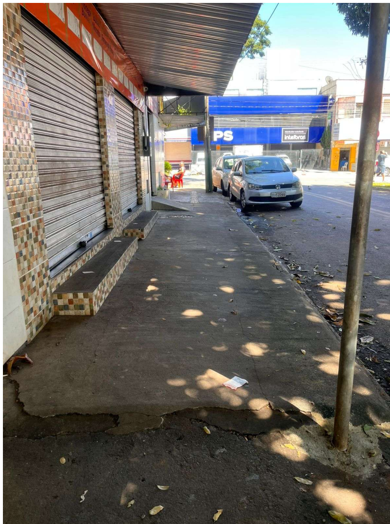
Figura 27 –Evidências do Bloco 3 - Inclinações na Rota da Rua 68
