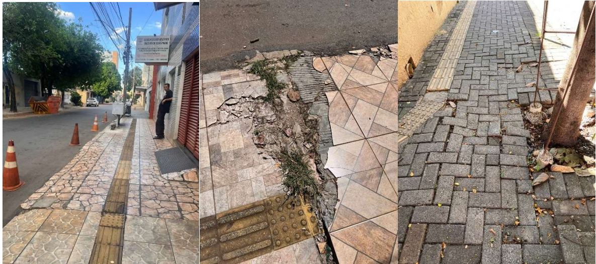
Figura 26 –Evidências do Bloco 2 – Condições do Pavimento na Rota da Rua 68
