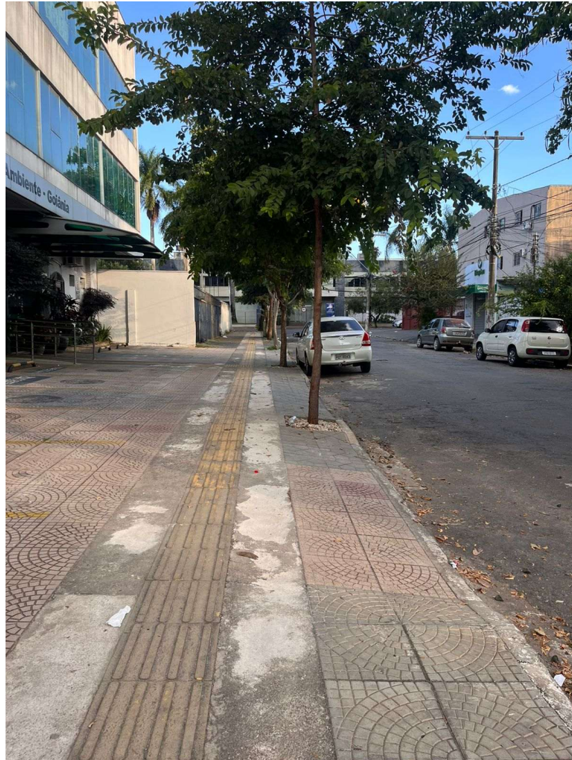
Figura 17 –Evidências do Bloco 3 -Inclinações na Rota da Avenida Goiás
