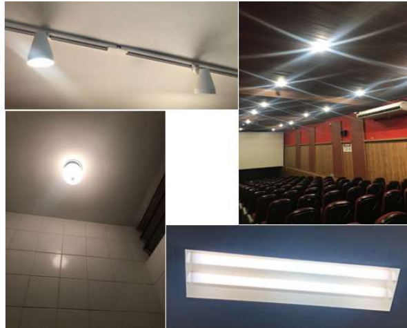
Figura 8 – Tipos de luminárias existentes no edifício
