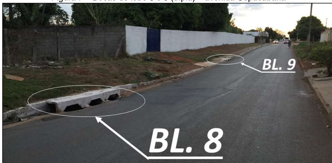
Figura 7 – Bocas de lobo 8 e 9 (tripla) – avenida Copacabana
