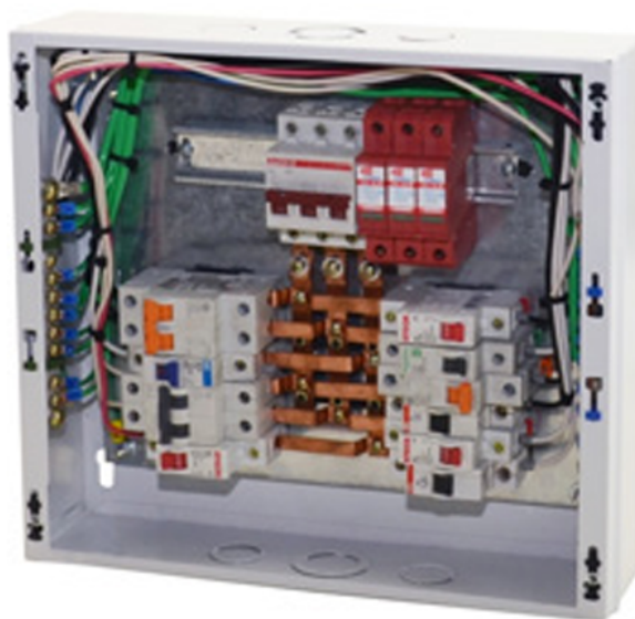
Figura 3.8: Quadro de distribuição trifásico
