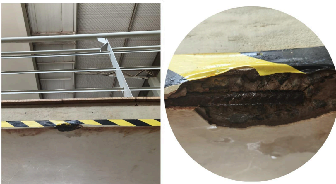
Figura 53 Carbonatação Viga De Borda De Escadaria
