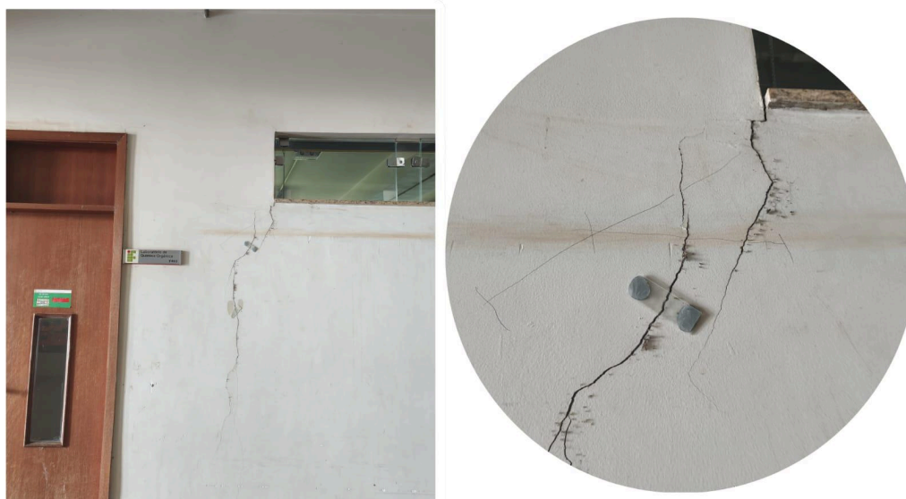
Figura 49 Trinca Diagonal, Partindo Do Vértice De Uma Janela.
