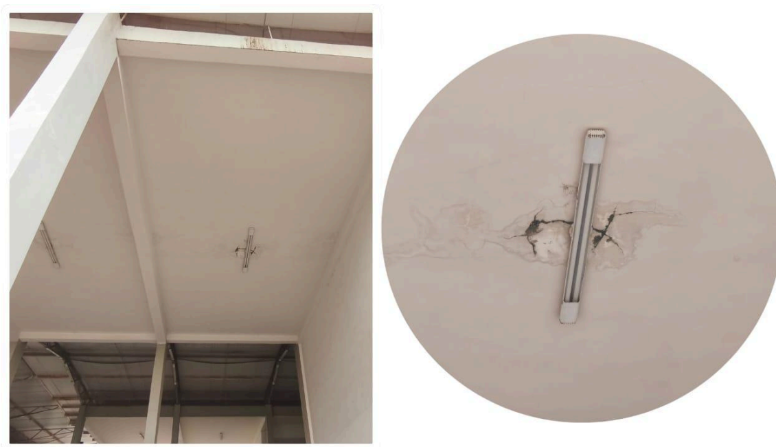
Figura 41 Infiltração Em Laje
