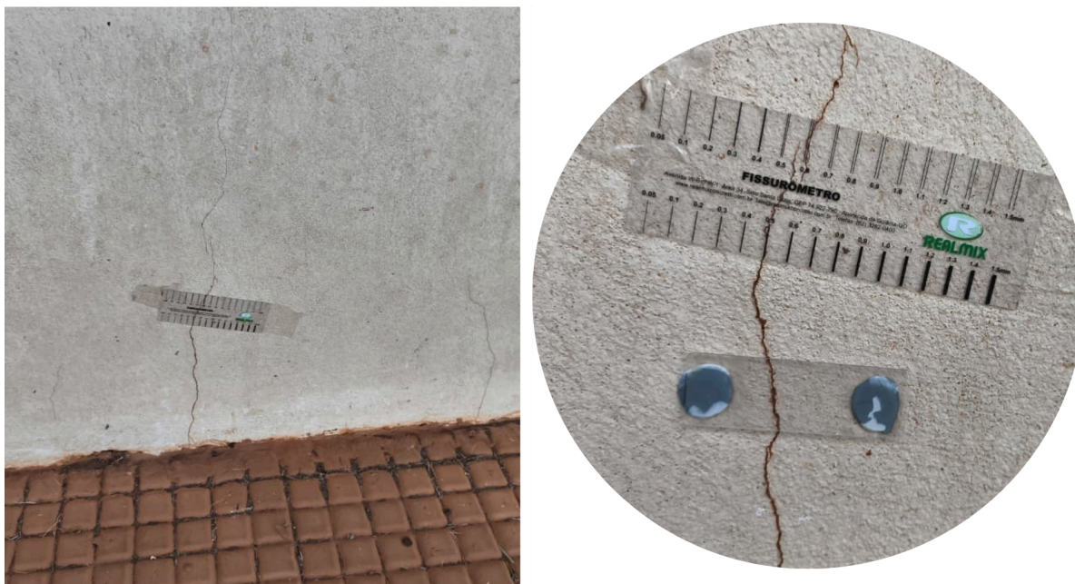
Figura 46 Fissura Na Parte Inferior Da Parede
