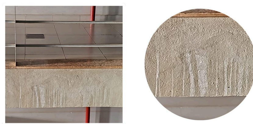
Figura 26 Eflorescência Face Externa De Uma Viga De Um Piso Em Nível Superior
