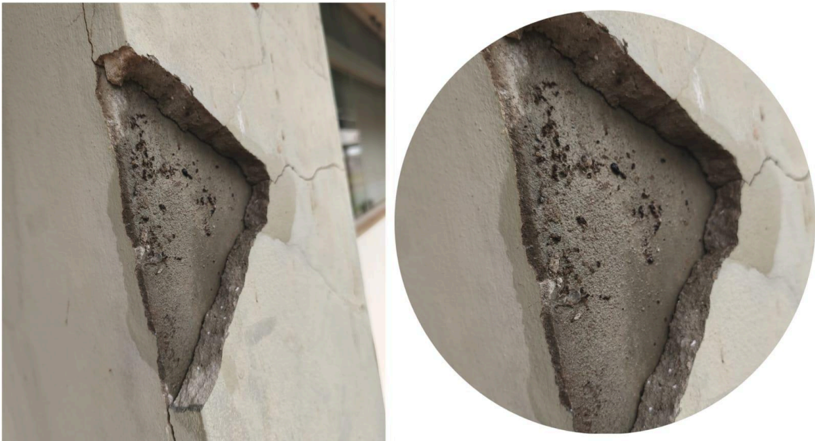
Figura 40 Desplacamento Em Pilar Externo
