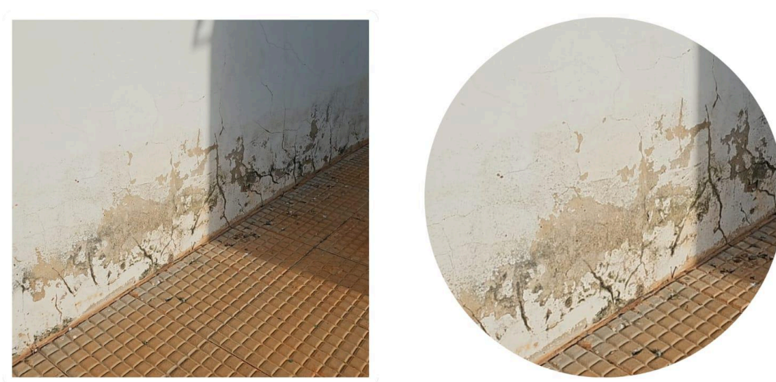
Figura 34 Capilaridade Na Parte Inferior Da Vedação Externa
