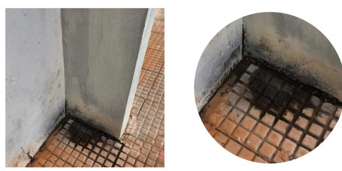
Figura 33 Capilaridade Na Interface Da Alvenaria De Vedação E Pilar Externos
