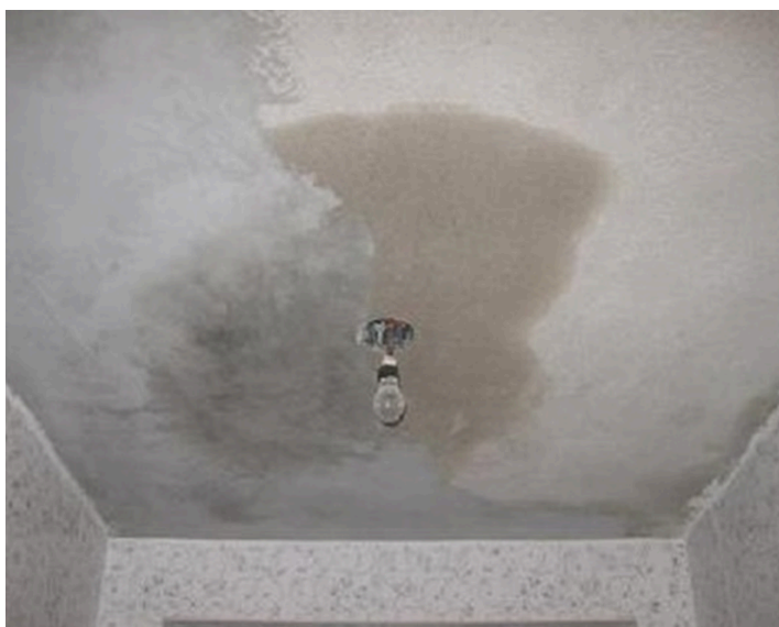
Figura 14 Manchas Recorrente A Infiltração No Teto
