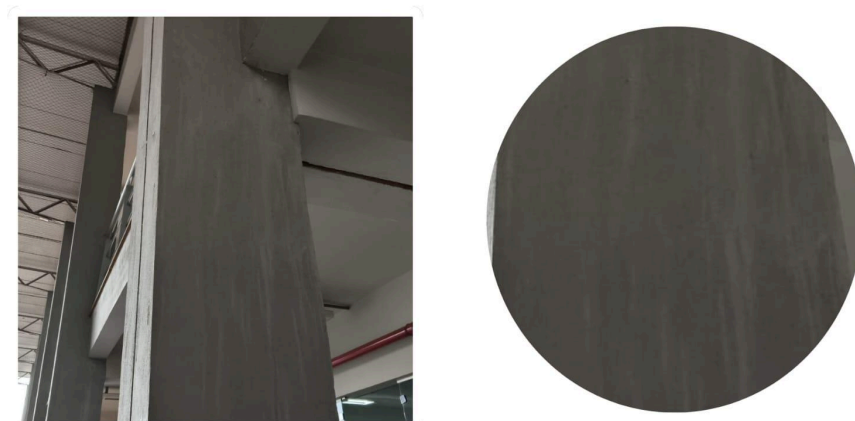
Figura 27 Eflorescência No Pilar
