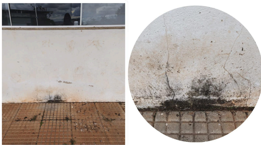
Figura 32 Capilaridade Na Parte Inferior Da Alvenaria De Vedação
