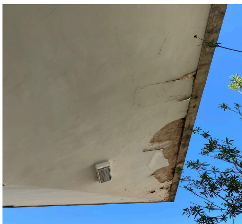
Figura 15 Destacamento No Teto
