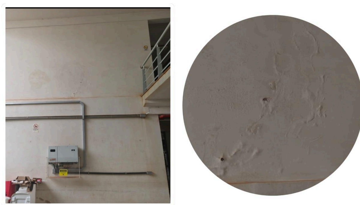
Figura 43 Bolhas E Enrugamentos Em Parede
