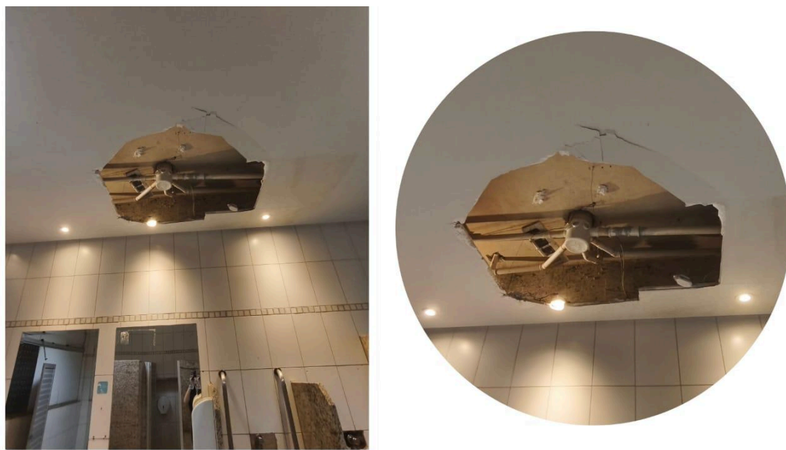
Figura 42 Infiltração Em Laje Do Banheiro
