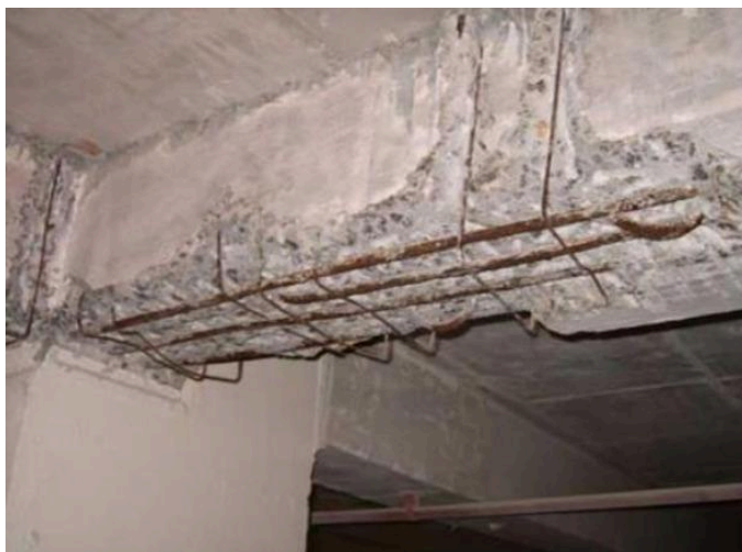
Figura 19 Desagregação Do Concreto
