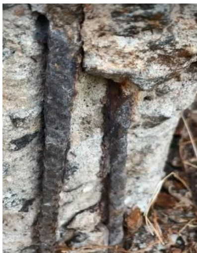
Figura 17 Processo De Corrosão De Armaduras
