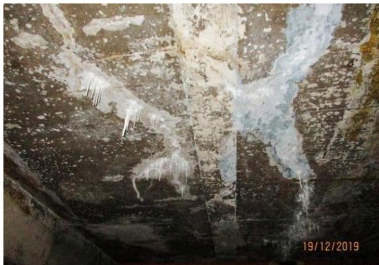
Figura 9 Lixiviação, Falta De Impermeabilização.
