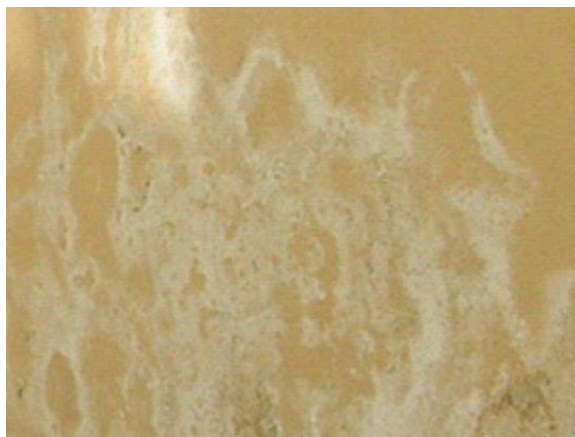
Figura 10 Eflorescência Na Pintura
