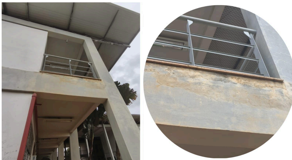
Figura 28 Lixiviação Em Viga De Borda Externa
