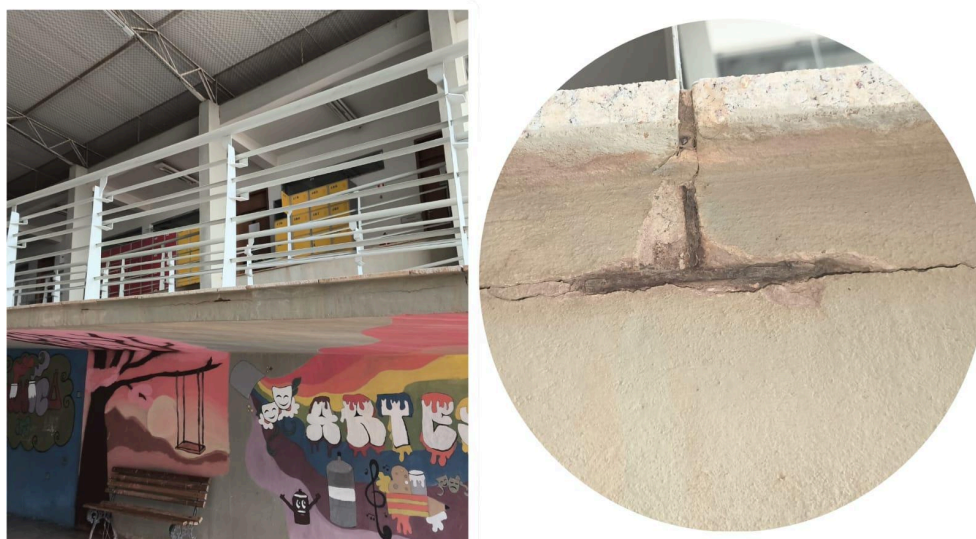
Figura 52 Carbonatação Viga De Borda De Rampa De Acesso
