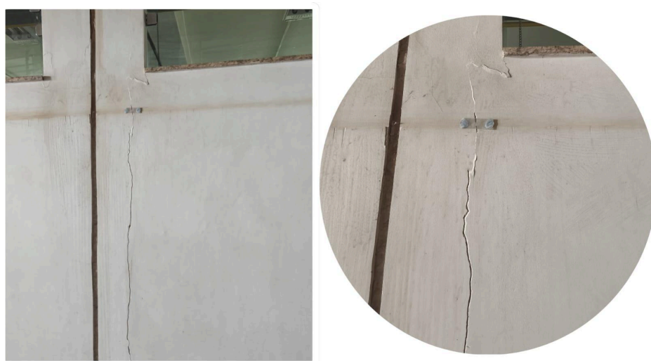
Figura 45 Fissura Vertical Ao Lado De Uma Junta De Dilatação
