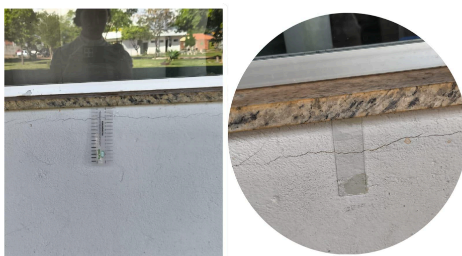
Figura 50 Fissura Horizontal Abaixo De Uma Janela.
