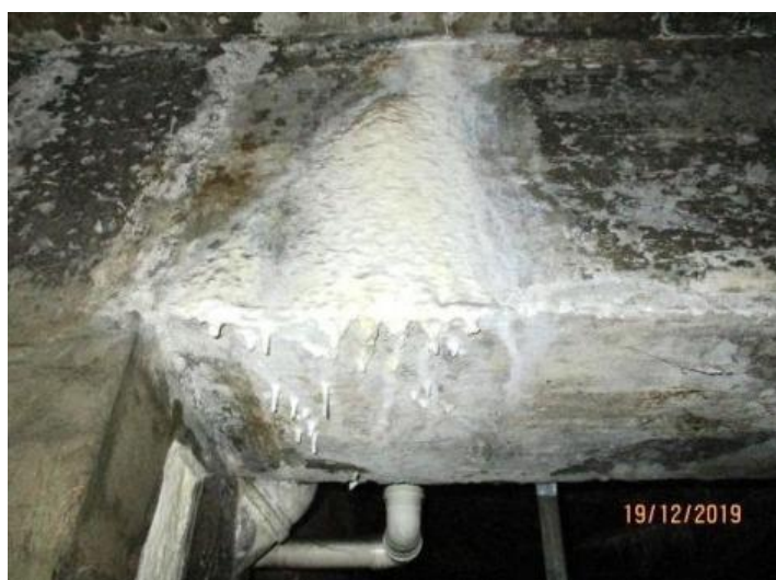
Figura 8 Lixiviação E Eflorescência.
