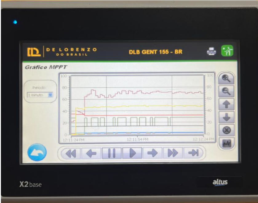
Figura 23 – Gráfico MPPT exibido na IHM para o Cenário 2, representando a variação de tensão, corrente e potência ao longo do tempo (1 minuto), com o aerogerador em 100% da velocidade.
