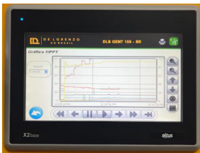
Figura 12 – Tela da IHM apresentando gráficos de tensão, corrente e potência para o gerador, banco de acumuladores e cargas.
