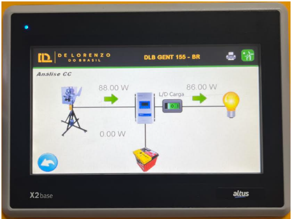
Figura 18 – Tela da IHM com ilustração do fluxo de energia do sistema para o Cenário 1, operando com o aerogerador em 100% da velocidade.
