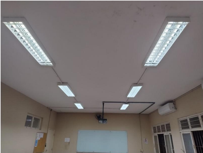
Figura 14 - Luminárias da Lâmapda LED
