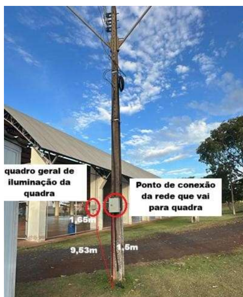
Figura 8 - Linha que alimenta o quadro de energia da quadra.
