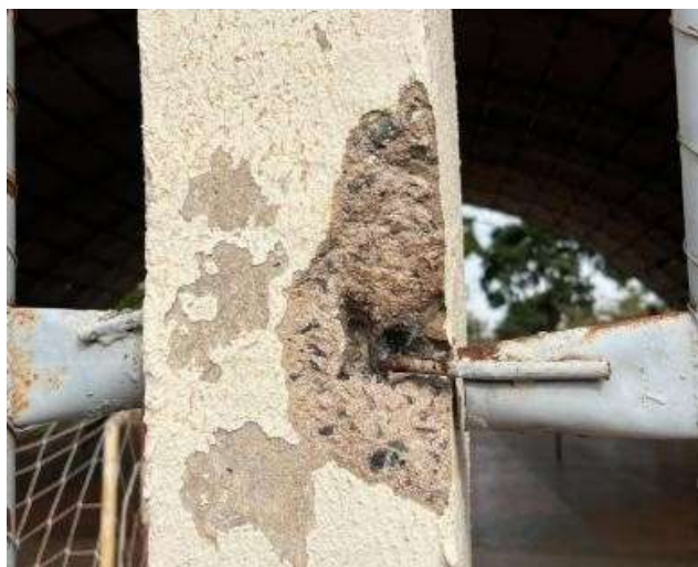
Figura 16 - Tubulação de fixação da grade metálica da quadra.
