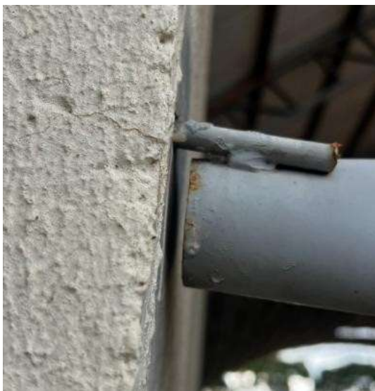
Figura 15 - Tubulação de fixação da grade metálica da quadra.
