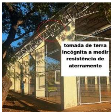
Figura 12 - Ponto de medição de resistência de aterramento da estrutura.
