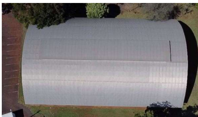
Figura 9 - Cobertura metálica da quadra utilizada como captor natural do SPDA.
