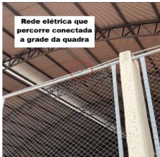
Figura 2 - Linha elétrica associada à iluminação da quadra poliesportiva.
