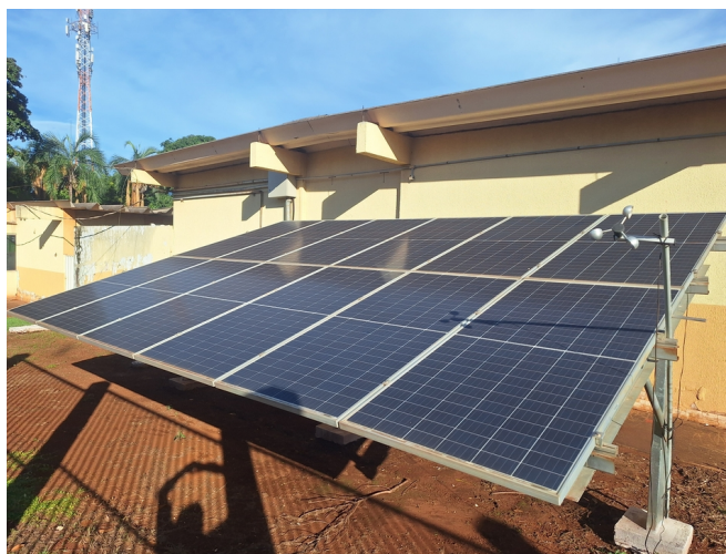
Figura 3 – Módulos fotovoltaicos instalados na microrrede.
