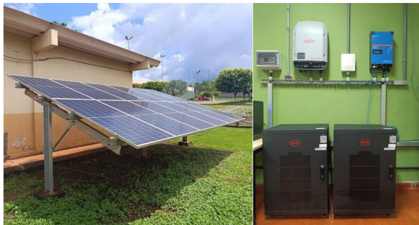
Figura 1 – Microrrede do Laboratório de Fontes Renováveis do IFG Campus Itumbiara.
