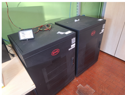
Figura 6 – Banco de baterias LiFePO 4 do sistema.
