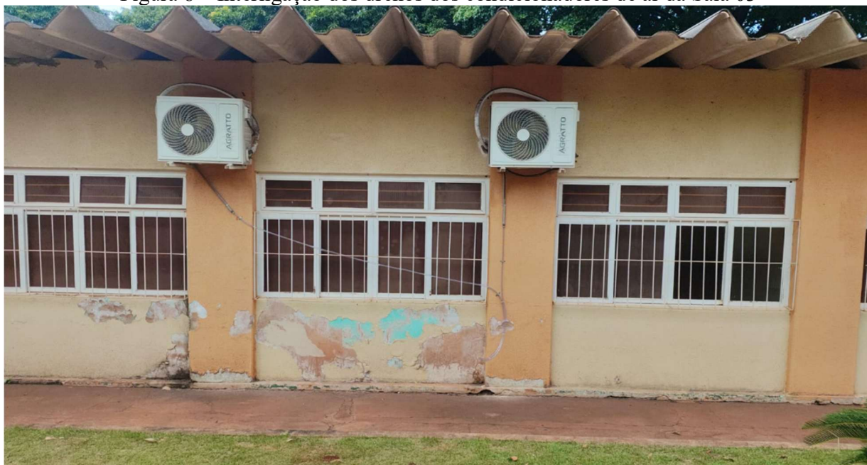
Figura 8 – Interligação dos drenos dos condicionadores de ar da Sala 03
