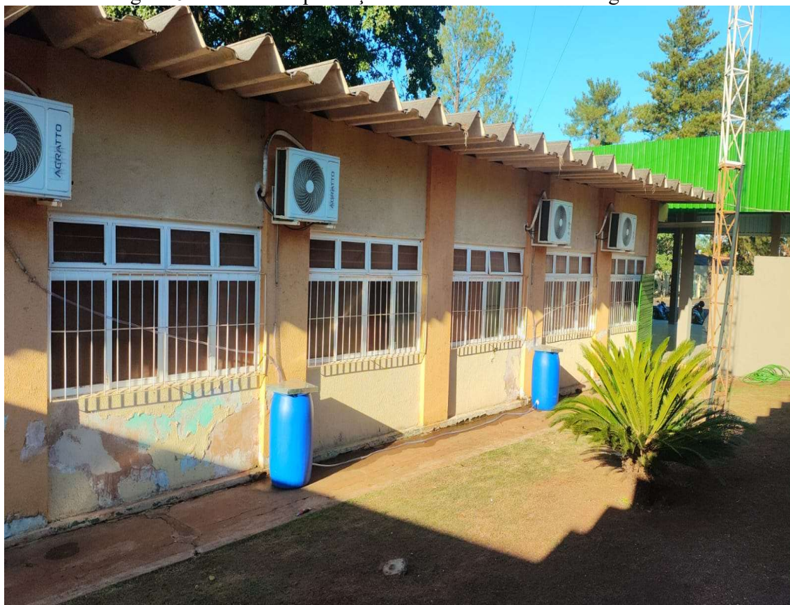
Figura 6 – local de implantação do sistema de coleta de água condensada.
