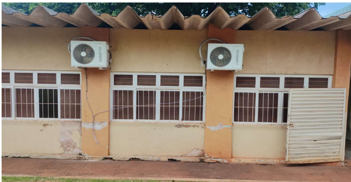
Figura 7 – Interligação dos drenos dos condicionadores de ar da Sala 02
