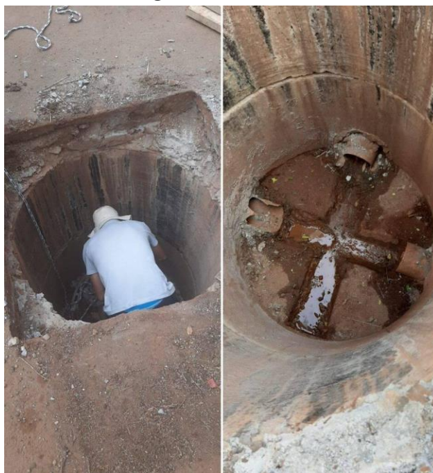
Figura 1 - Poço de visita
