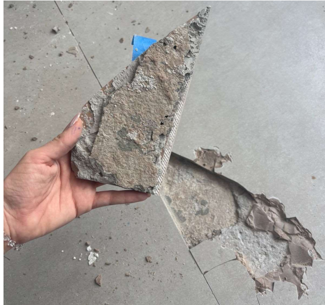
Figura 21 - Piso Oco: falha de aderência piso/contrapiso.
