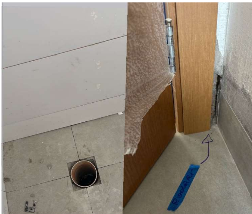
Figura 19 - Revestimento de piso: ausência de instalação de porta-grelha e de rodapé.
