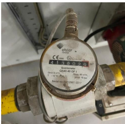
Figura 38 – Medidor de gás Elster. Fonte: Fonte [Autor].
