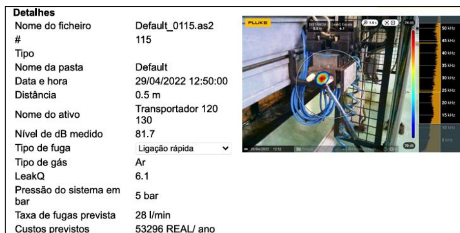
Figura 60 –Vazamento ar comprimido engate rápido no transportador. Fonte [Autor].
