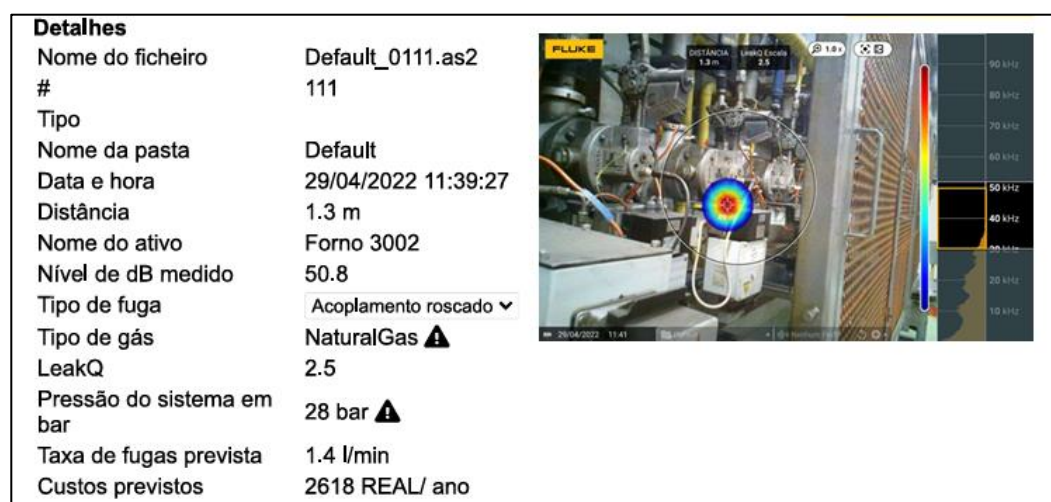
Figura 57 –Vazamento ar comprimido forno. Fonte [Autor]
