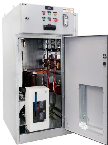
Figura 40 - Cubículo Blindados de Média Tensão. Fonte [20].
