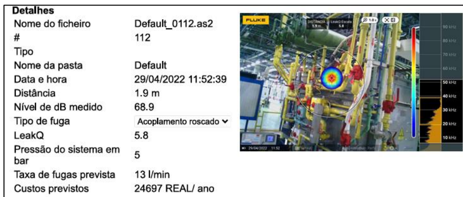
Figura 61 – Vazamento do tipo roscado tubulações. Fonte [Autor].
