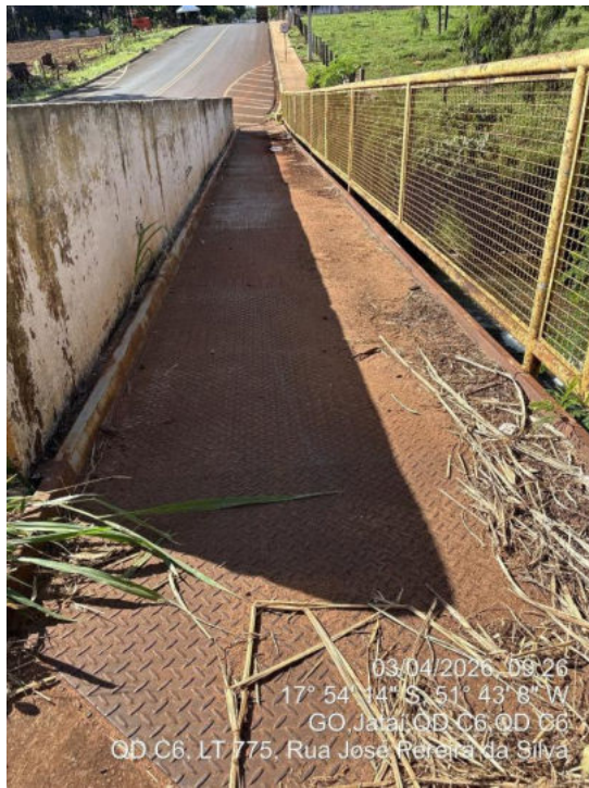
Figura D.5 — Corrosão e obstrução do passeio direito por vegetação e detritos.
