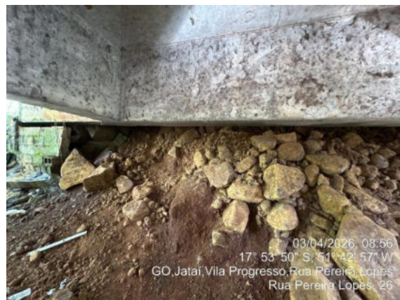
Figura B.6 — Erosão acentuada no aterro do encontro.
