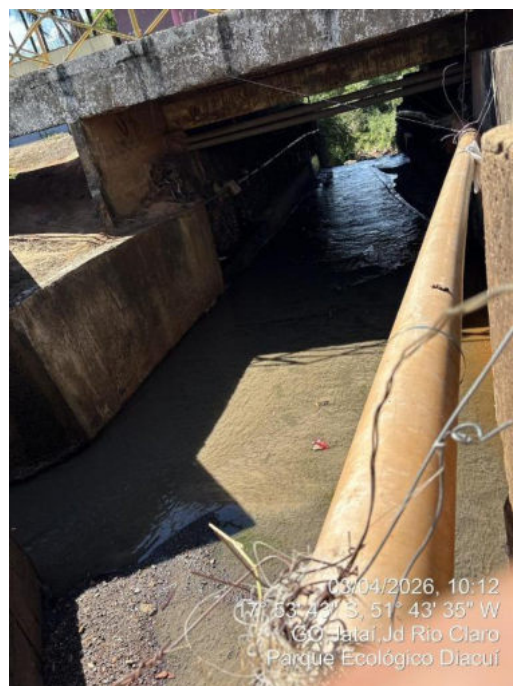
Figura A.8 — Lixiviação e eflorescência nos encontros.
