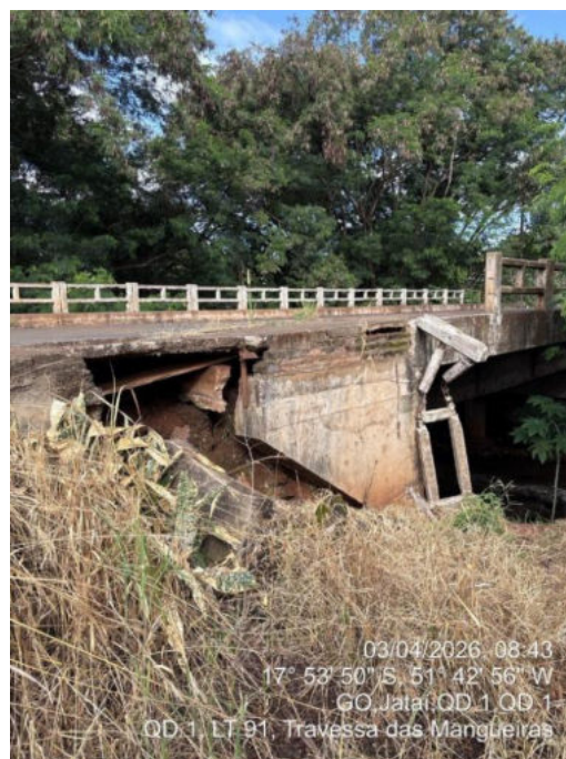
Figura B.8 — Ruptura e colapso parcial do encontro.
