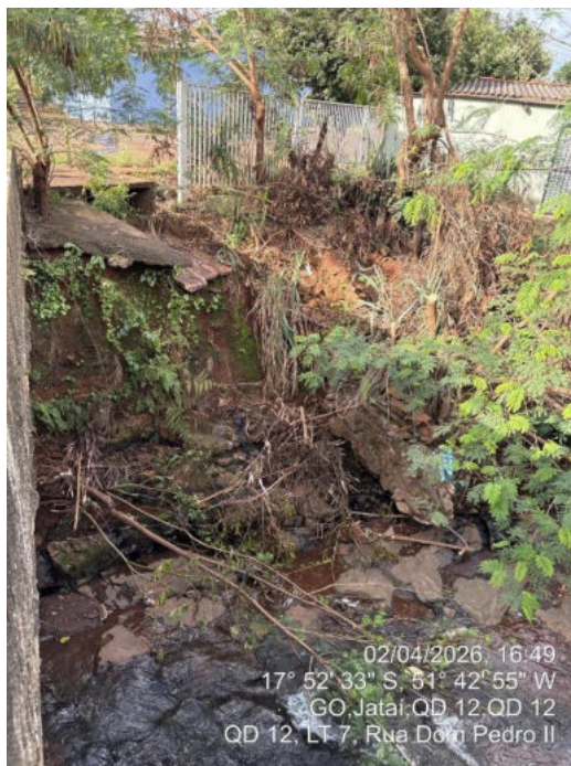
Figura I.9 — Ruptura da estrutura de drenagem.
