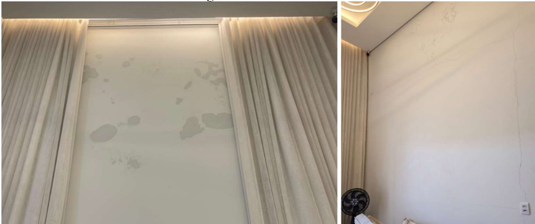
Figura 11 - Fissuras na sala
