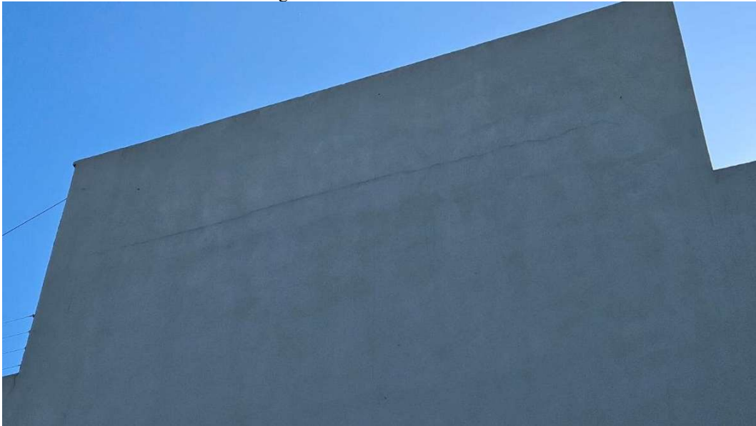
Figura 12 - Fissura no barrilete
