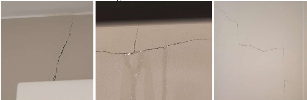
Figura 10 - Fissuras na Suíte
