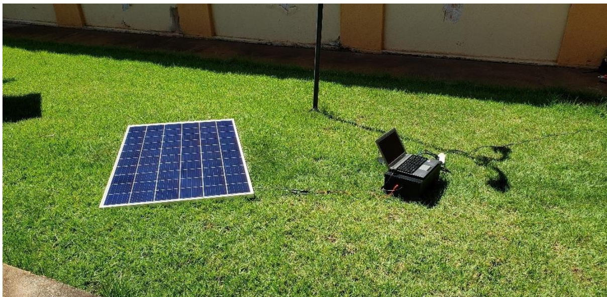
Figura 54 - Ensaio com módulo FV orientado para o norte. Fonte [Autor].
